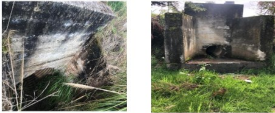
Ilustración 27. Fotografías de alcantarillas en campo
