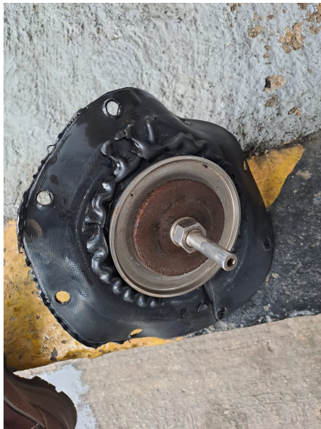
Figura 1.4: Diafragma dañado por presión excesiva
