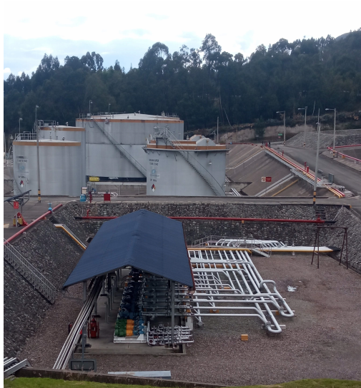
Figura 3.5: Área de Bombas (2)
