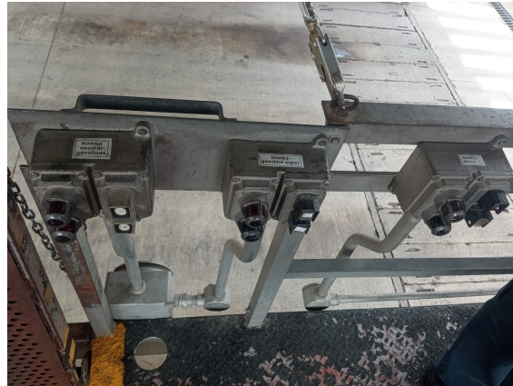
Figura 3.6: Botonera de accionamiento de bombas
