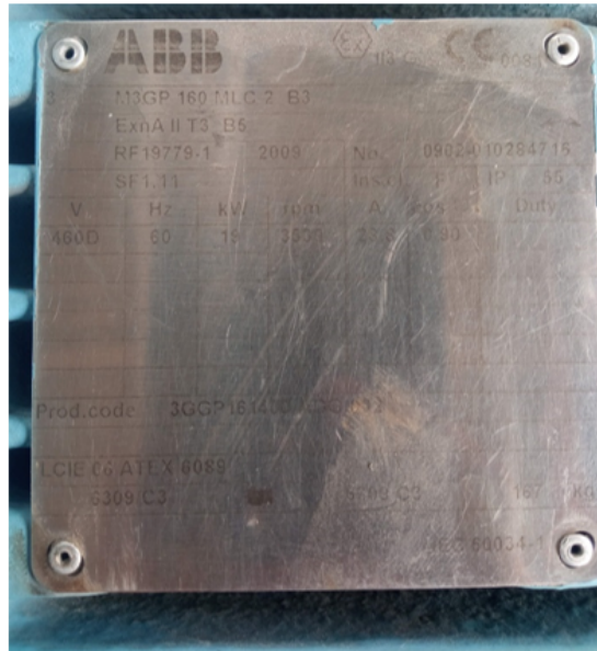
Figura 3.42: Placa de motor ABB del Cuarto de Bombas de la Terminal de Productos Limpios de Cuenca
