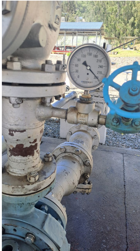
Figura 1.5: Manómetro reventado por presión excesiva
