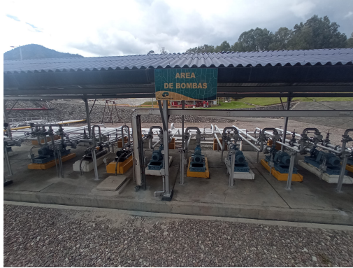
Figura 3.4: Área de Bombas (1)
