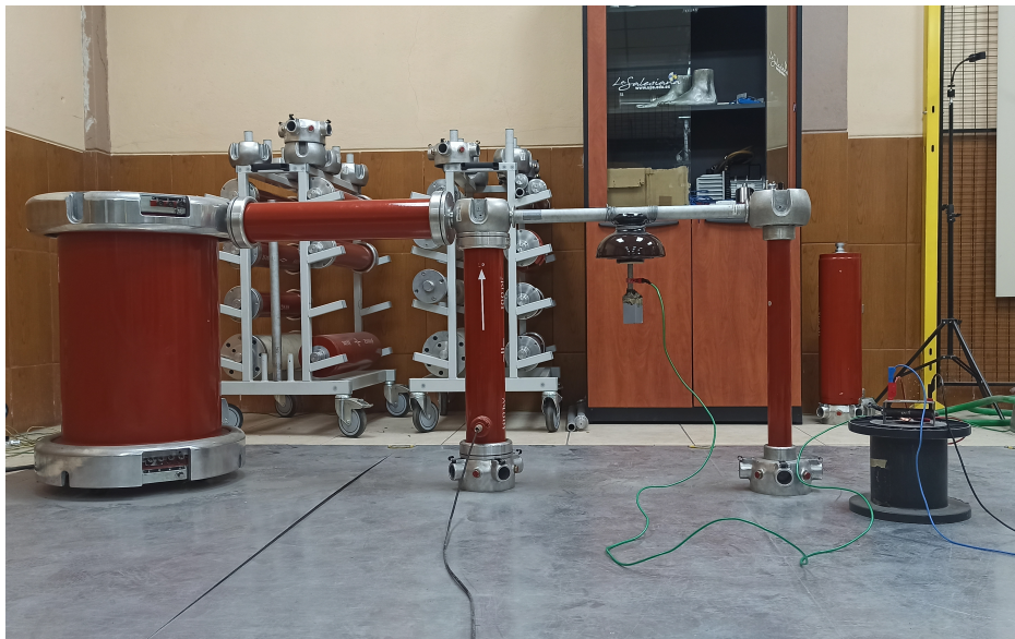
Figura 17: Circuito experimental desarrollado en el Laboratorio de Alta Tensión de la UPS para un aislante de porcelana ANSI 55-5.
