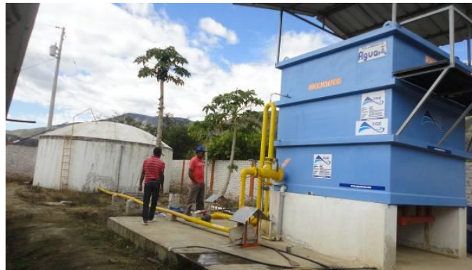
Planta de tratamiento compacta, Pusir Grande
