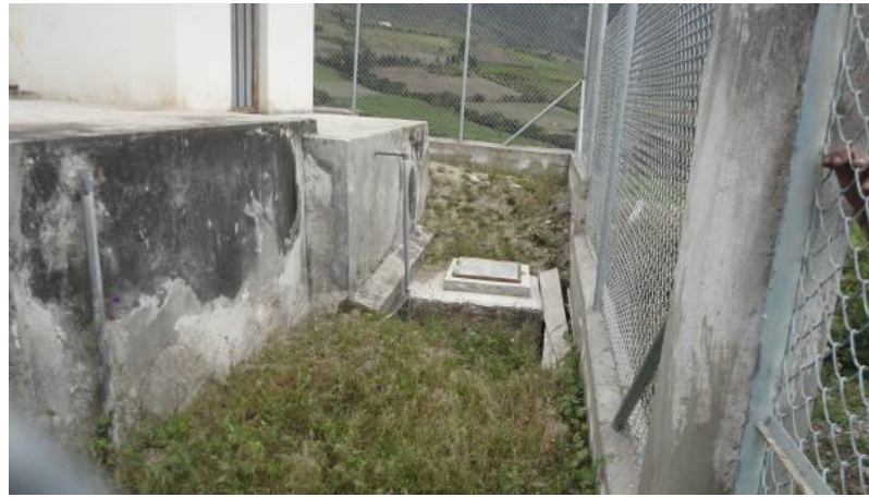
Tuberías de reboso de El Tambo
