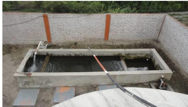
Planta de tratamiento compacta, Pusir Grande
