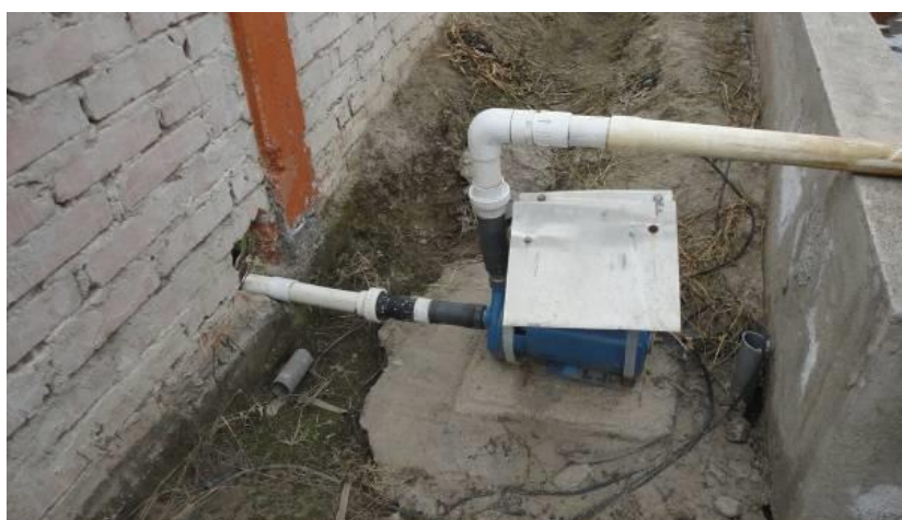
Línea de impulsión Pusir Grande
