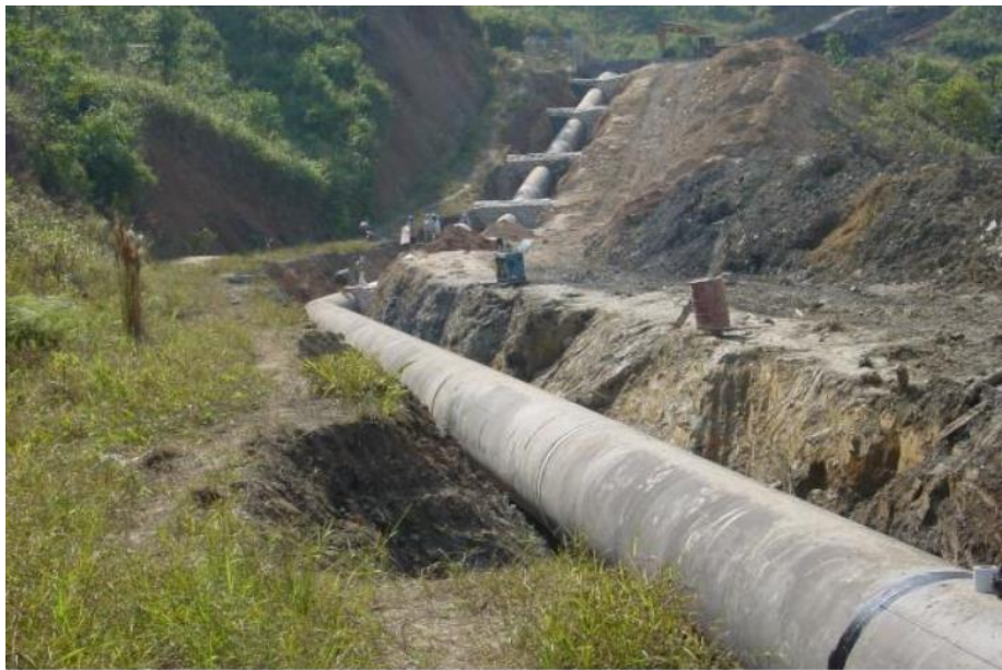
Ilustración 5: Tubería de presión
