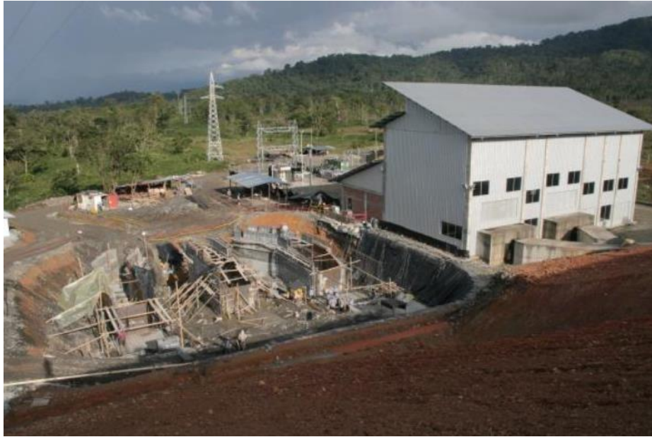
Ilustración 8 Casa de máquinas
