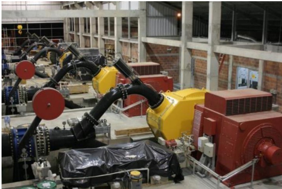
Ilustración 7 Turbinas instaladas Fuente: (SIPETROL S.A, 2008)
