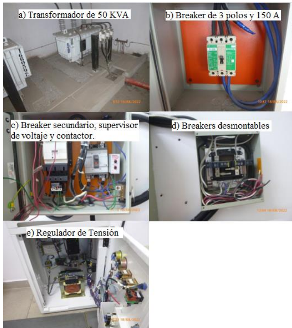
Figura 11 Elementos que alimentan el tablero de rayos X. Fuente: Autor.
