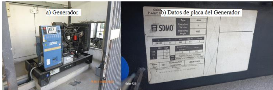
Figura 2 Grupo electrógeno del Hospital Fuente: Autor.
