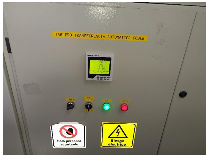
Figura 13 Indicadores Tablero de transferencia.
