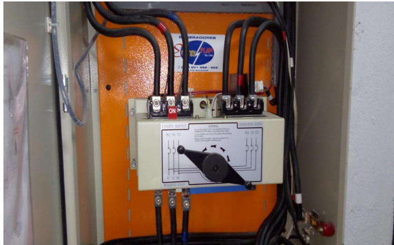
Figura 14 Tablero de Transferencia manual.
