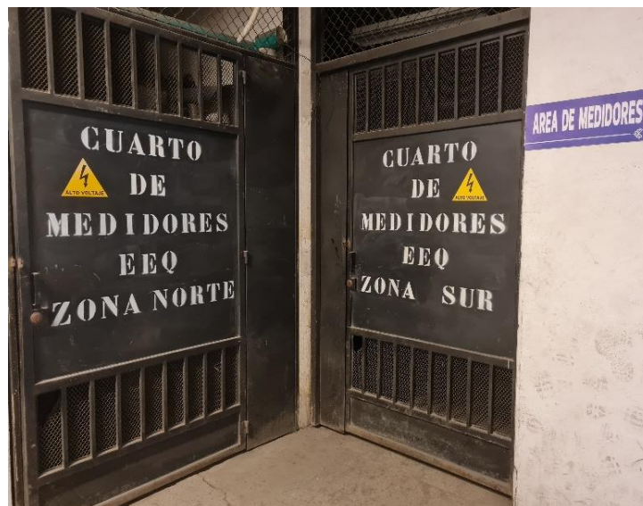
Figura 22 Cuarto de medidores etapa 1.
