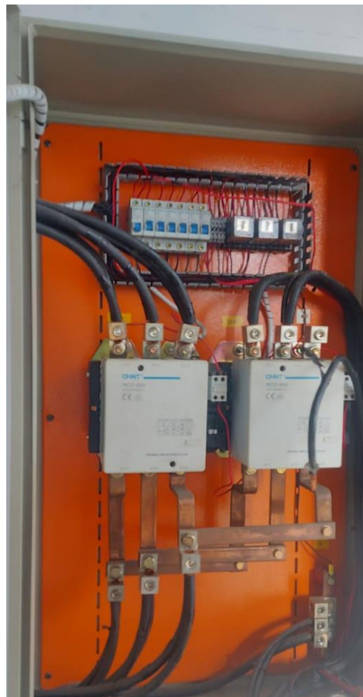
Figura 15 Tablero de Transferencia automático.
