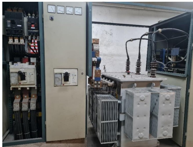
Figura 20 Transformador 750 kVA etapa 1.
