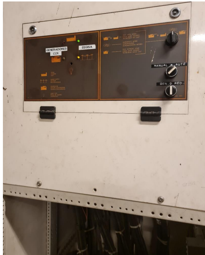
Figura 23 Cuarto de medidores etapa 1.
