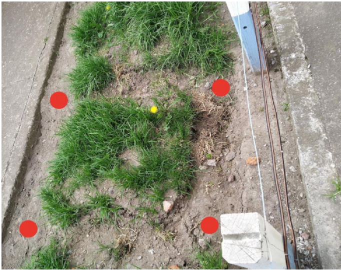
Figura 55. Malla de puesta a tierra instalada. Fuente: Autor.
