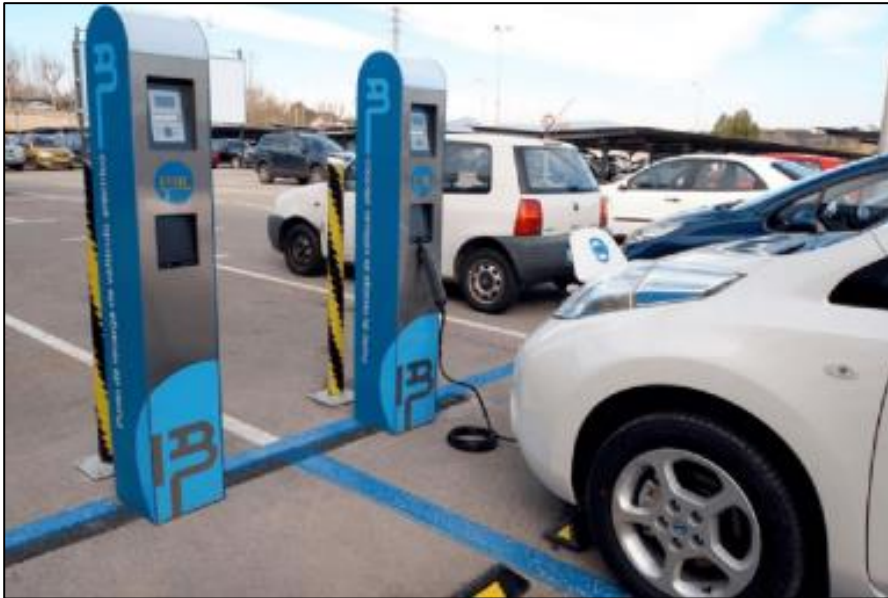
Figura 1. Ejemplo de sitios de carga para vehículos eléctricos.
