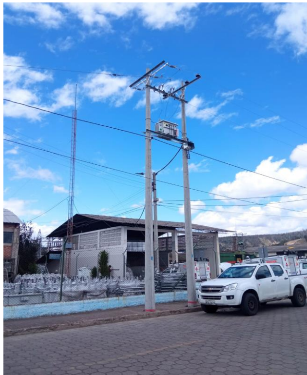
Figura 46. Transformador 100 KVA. – alimentación cargadores.
