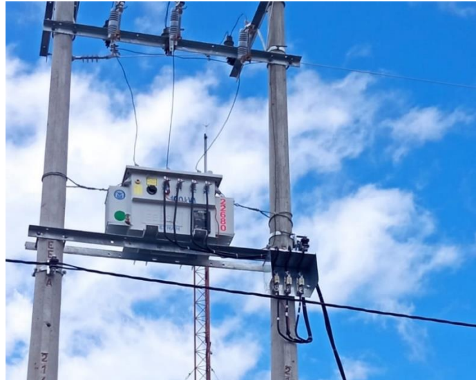
Figura 47. Protecciones en M.T. y B.T. Fuente: Autor.
