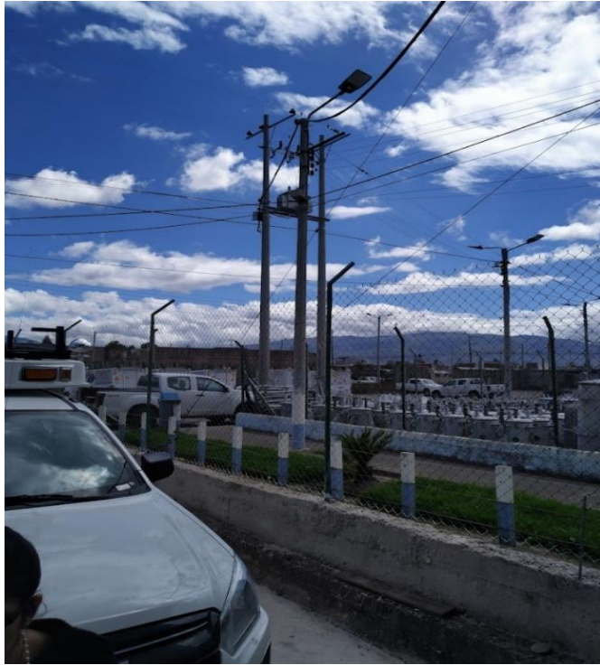
Figura 48. Acometida de alimentación cargadores. Fuente: Autor.
