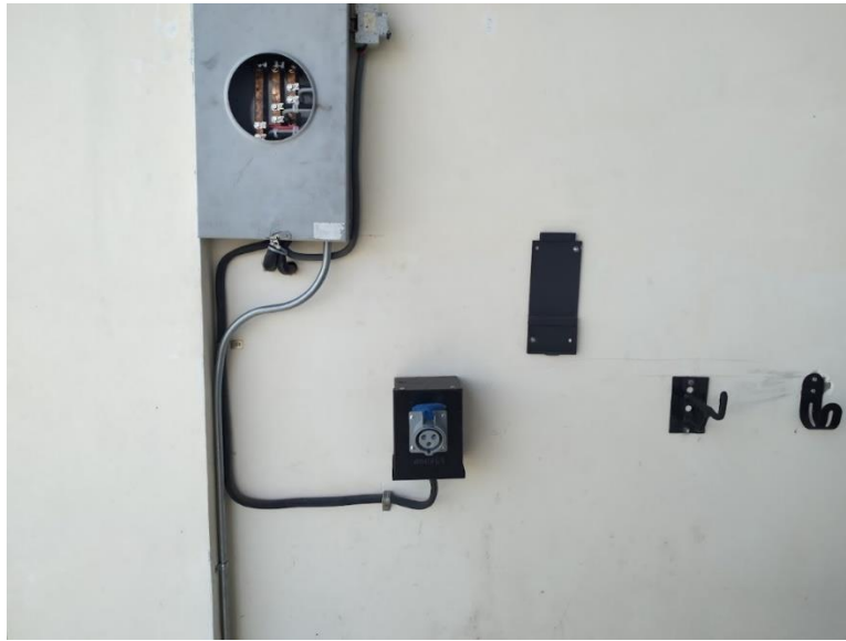
Figura 51. T.D.P. enlazado a punto de conexión. Fuente: Autor.
