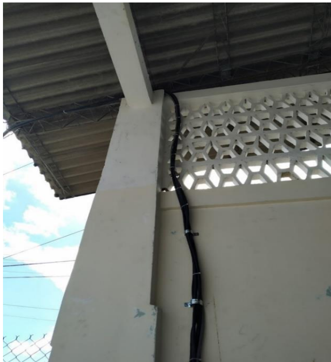
Figura 49. Bajante de acometida a T.D.P. Fuente: Autor.
