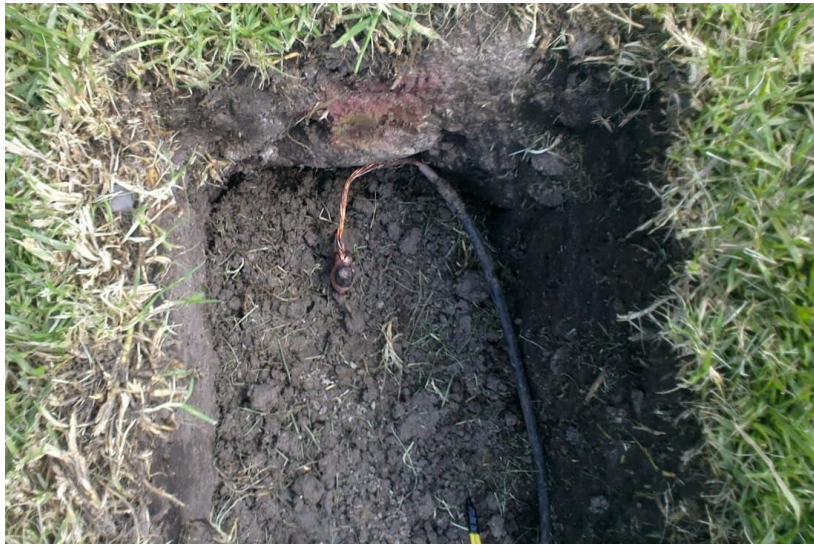
Figura 53. Salida de conductor hacia T.D.P. Fuente: Autor.
