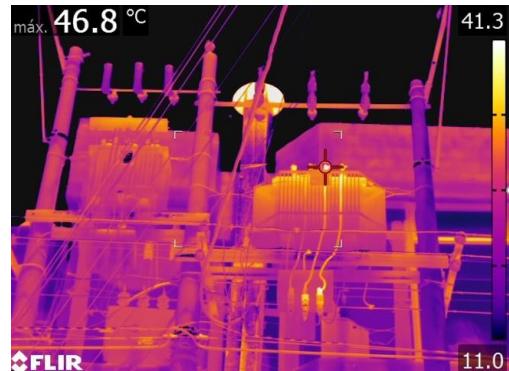
Figura 4. Imágen termográfica en el sector A-04 Chimbacalle.
