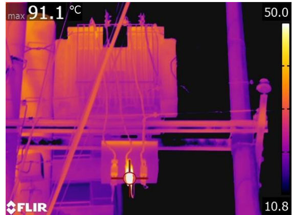
Figura 12. Punto caliente en el fusible NH en la fase v con efecto térmico.
