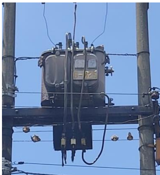
Figura 11. Transformador sin efecto térmico.
