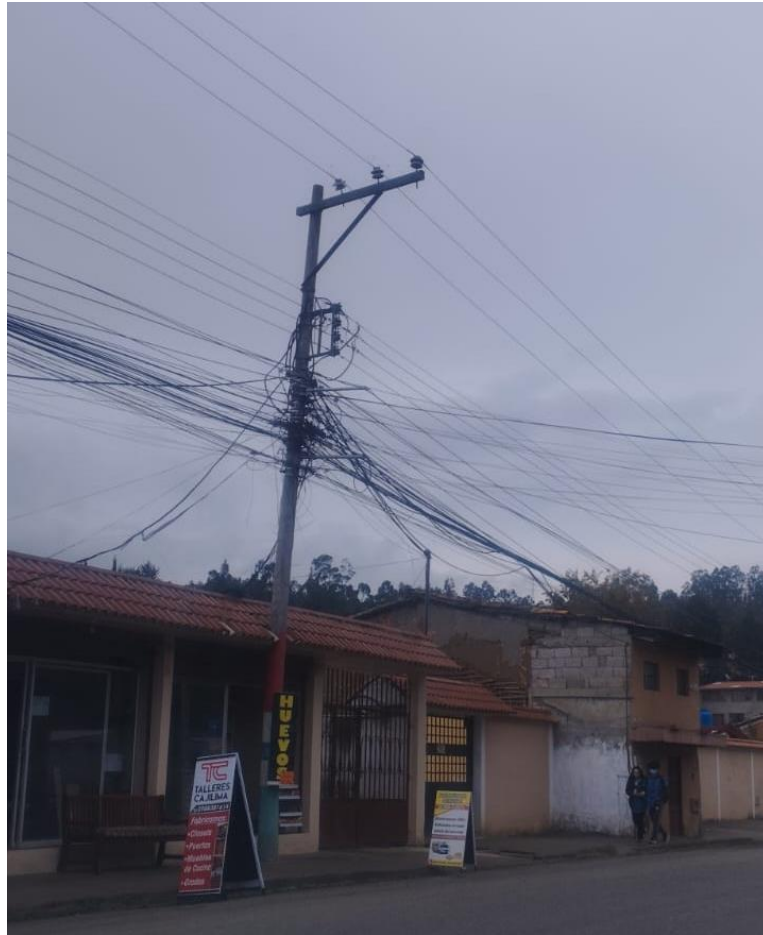
Figura 2.10: Poste con saturación de cables. Fuente: Autores.
