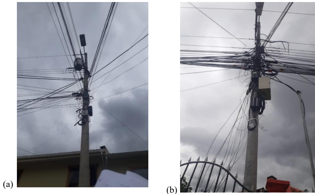
Figura 2. 6 Postes considerados como restricciones a) poste con transformador, b) poste con exceso de cable y cajas de distribución.
