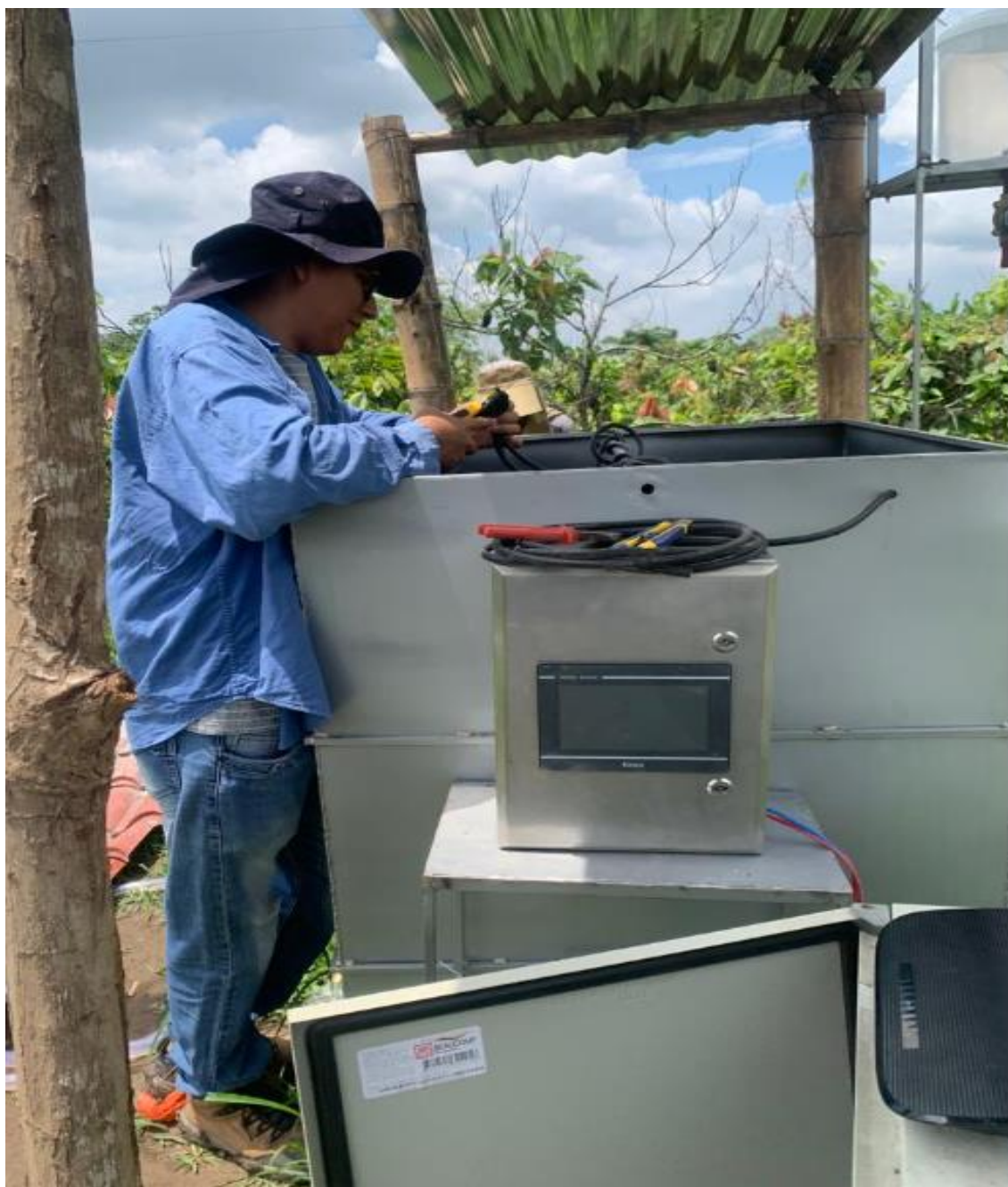
Anexos-10 Cableado de resistencias eléctricas.
