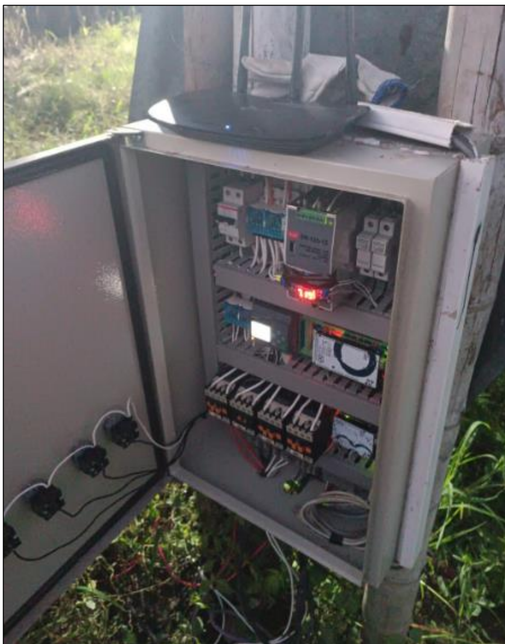
Anexos-13 Tablero principal operativo.
