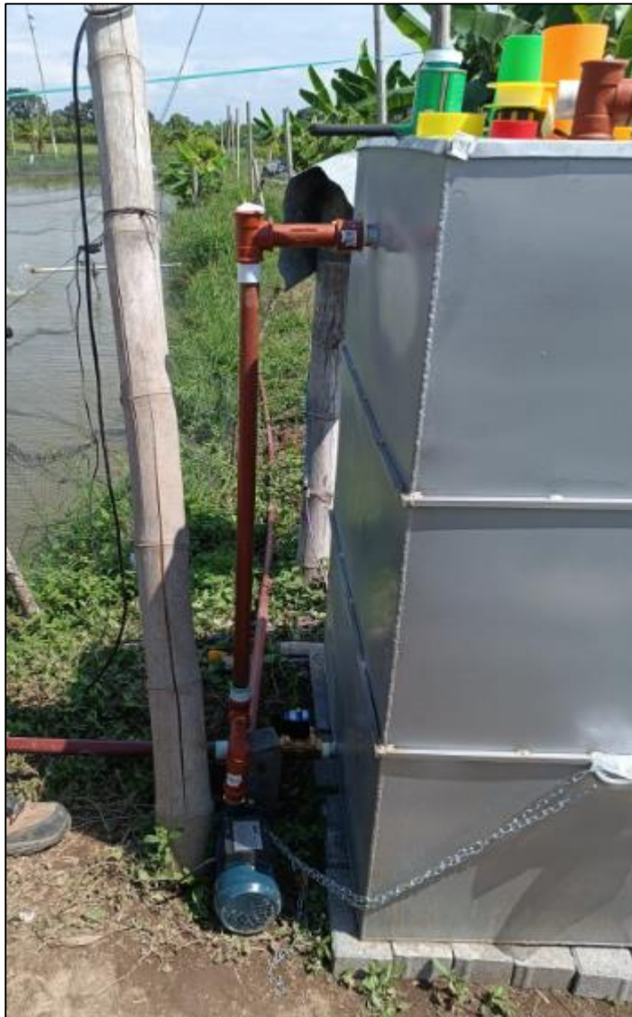
Marco metodológico-20 Bomba instalada al tanque metálico.
