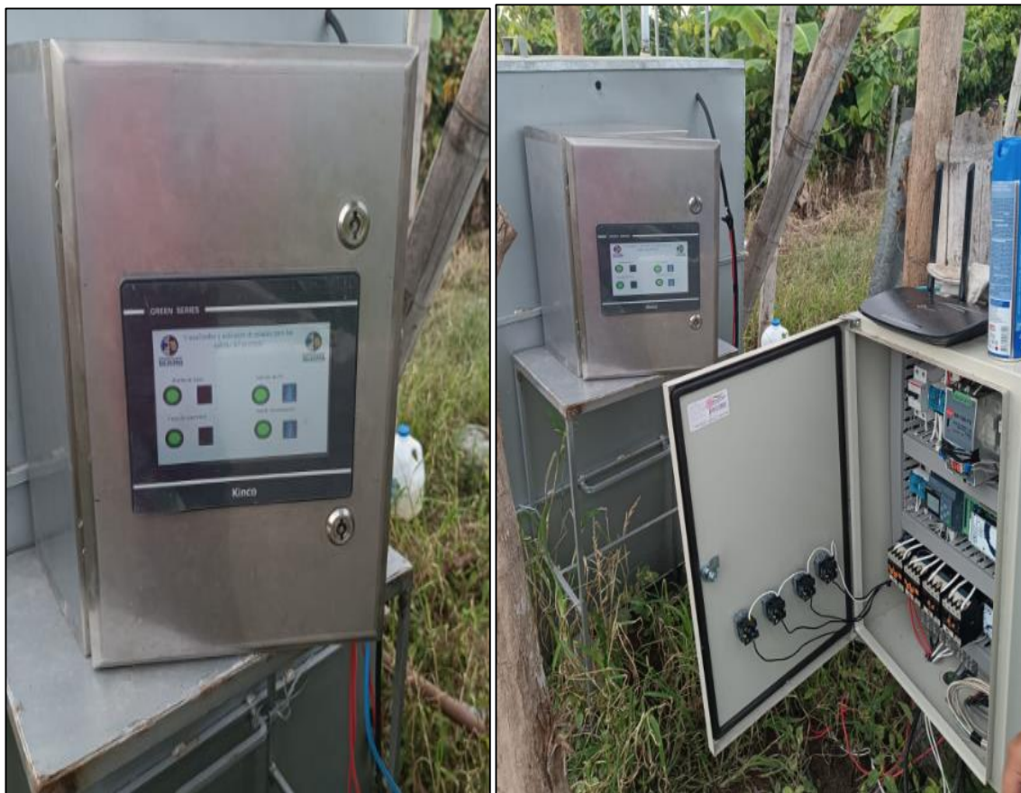
Anexos-17 Tableros eléctricos entrelazados y operativos.
