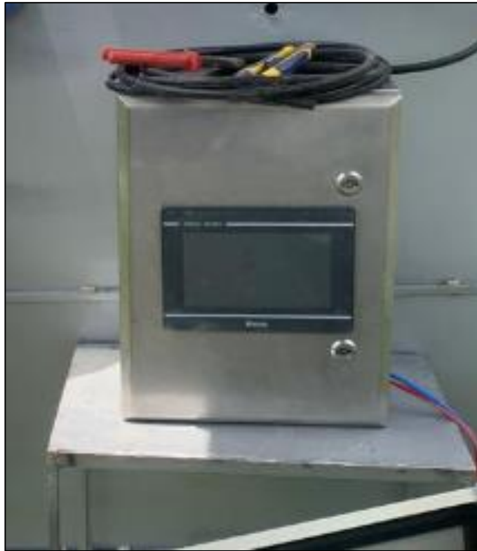
Marco metodológico-23 Vista frontal de tablero con HMI.
