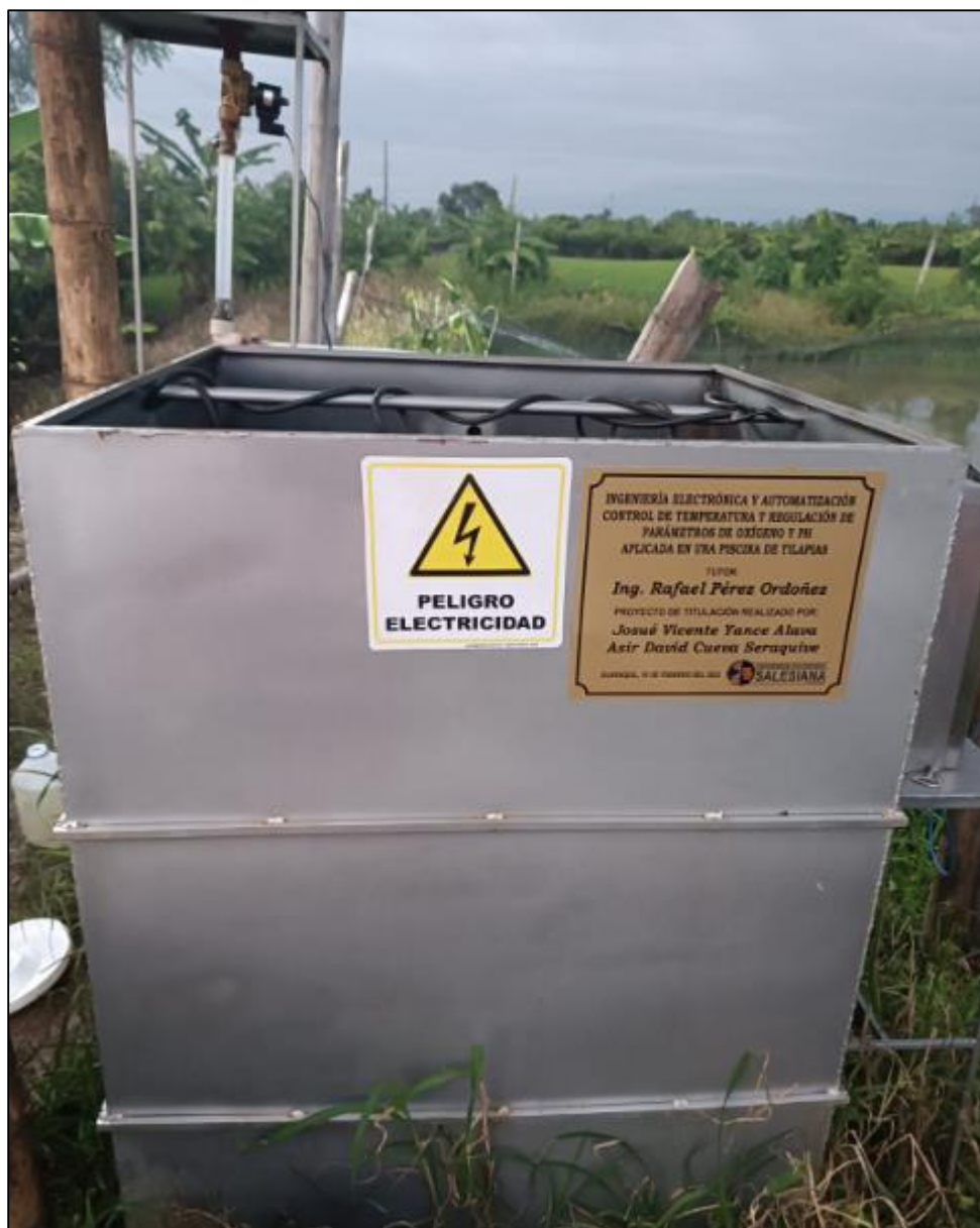
Anexos-15 Tanque en correcta operación.
