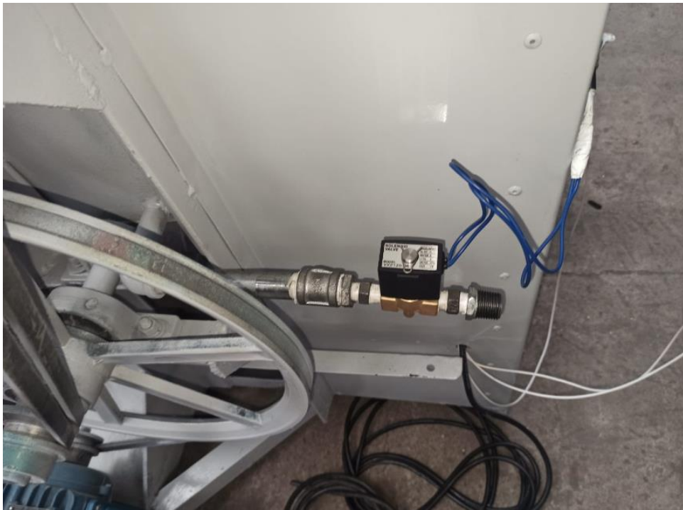
Figura 3.42: Implementación de electroválvula para paso de vapor.
