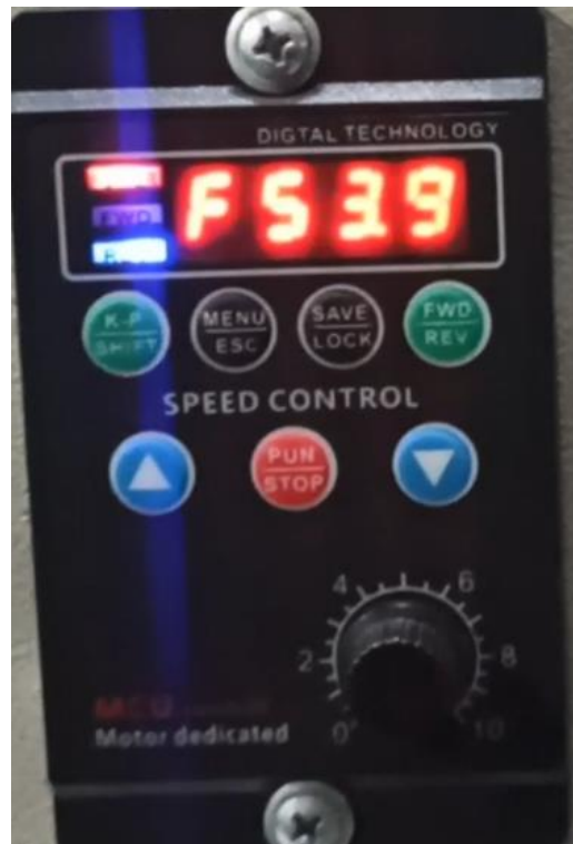
Figura 4.13 Variador de frecuencia funcionando.
