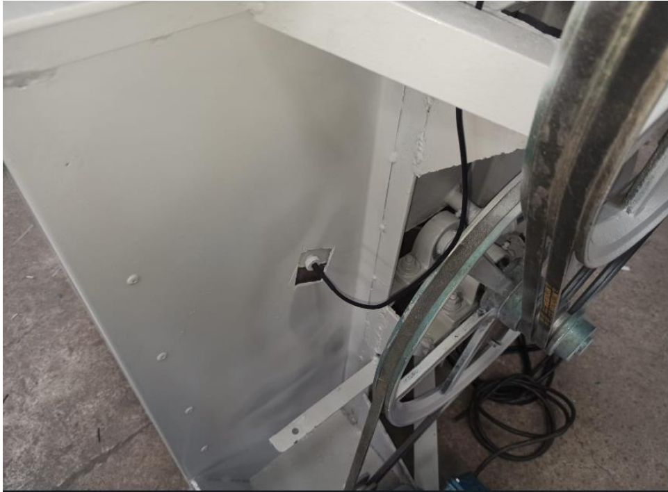
Figura 3.41: Colocación sensor de Temperatura DS18B20.
