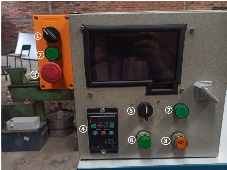
Figura 3.48: Implementación elementos de control manual.
