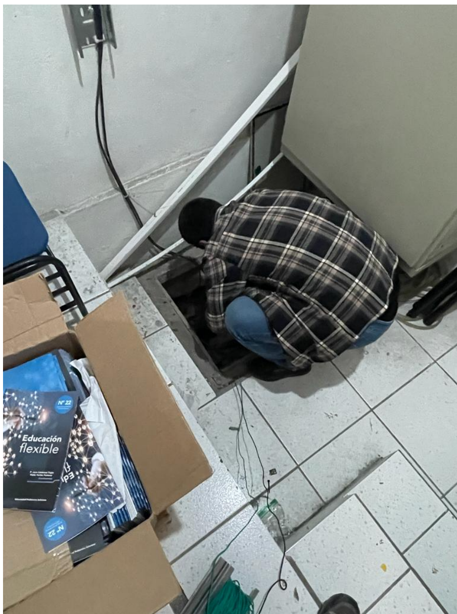
Figura A.2: Medición de resistencia de malla de puesta a tierra del edificio Guillermo Mensi
