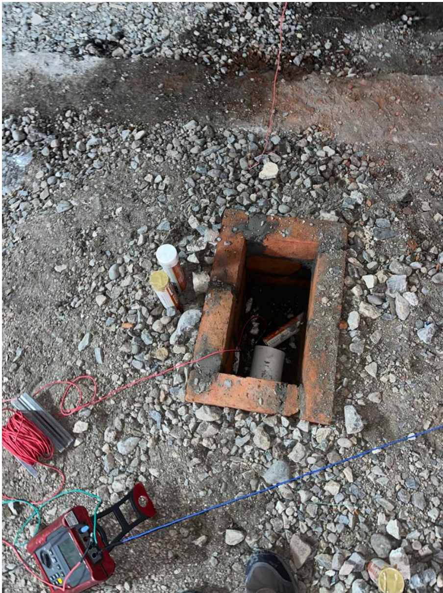
Figura A.1: Medición de resistencia de malla de puesta a tierra del laboratorio de alta tensión
