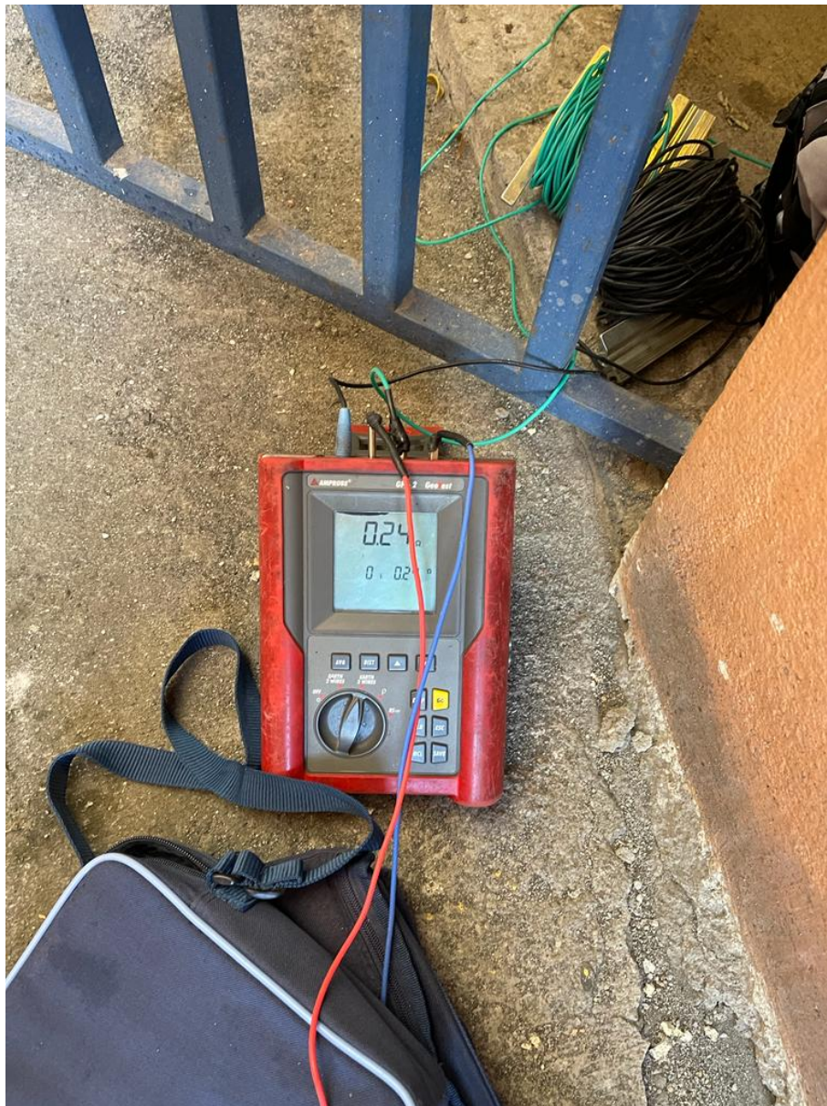
Figura A.7: Medición de resistencia de malla de puesta a tierra del transformador ubicado a un lado del edificio CIMA
