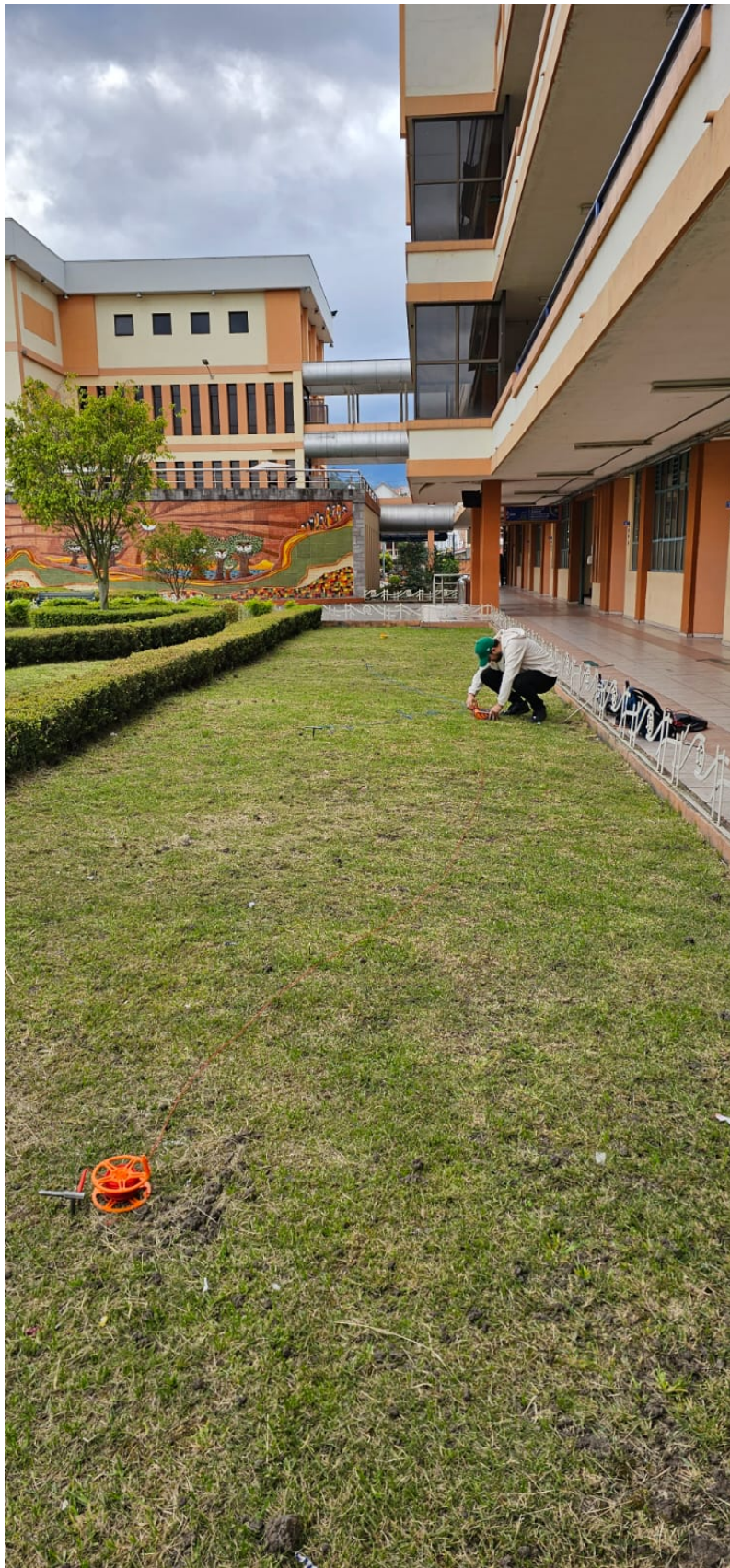
Figura B.2: Medición de resistividad del suelo alrededor del edificio Mario Rizzini, Terreno 2
