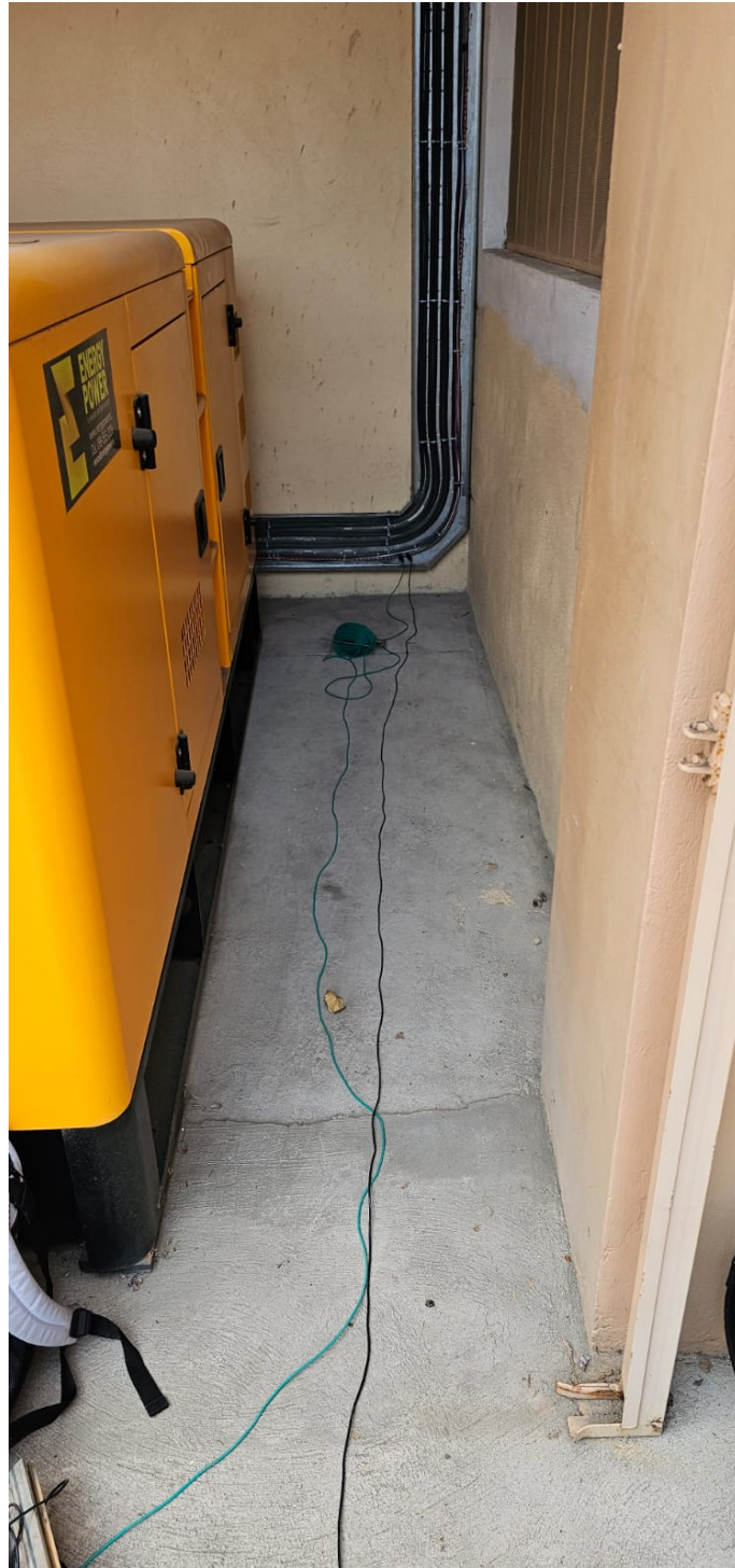
Figura A.6: Medición de resistencia de malla de puesta a tierra del generador del edificio Juan Botasso
