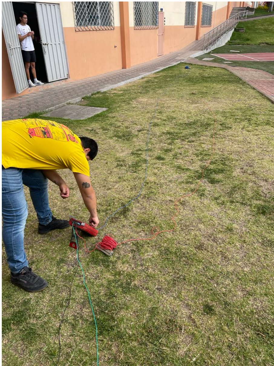
Figura A.5: Medición de resistencia de malla de puesta a tierra del transformador ubicado en la parte posterior al edificio de Automotriz
