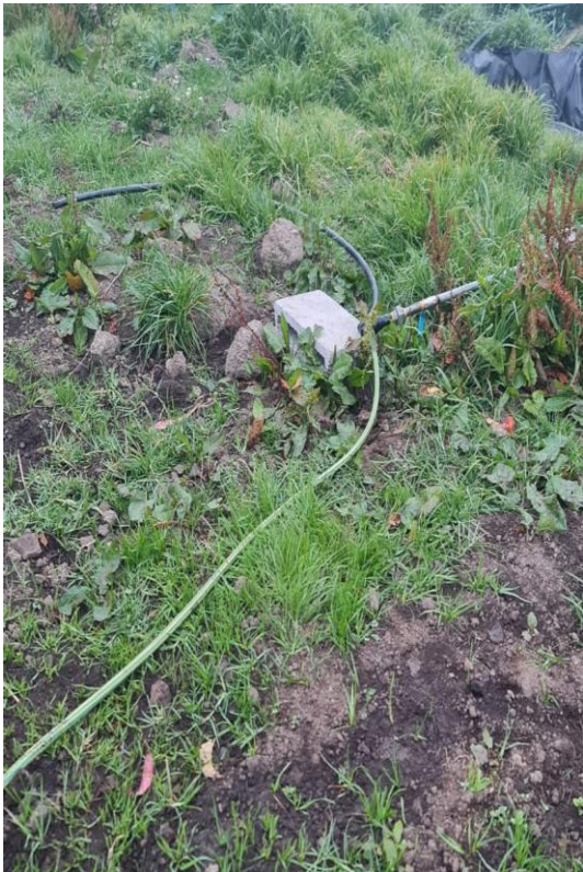
Anexos 11. División de sistema de gas y trampa de agua
