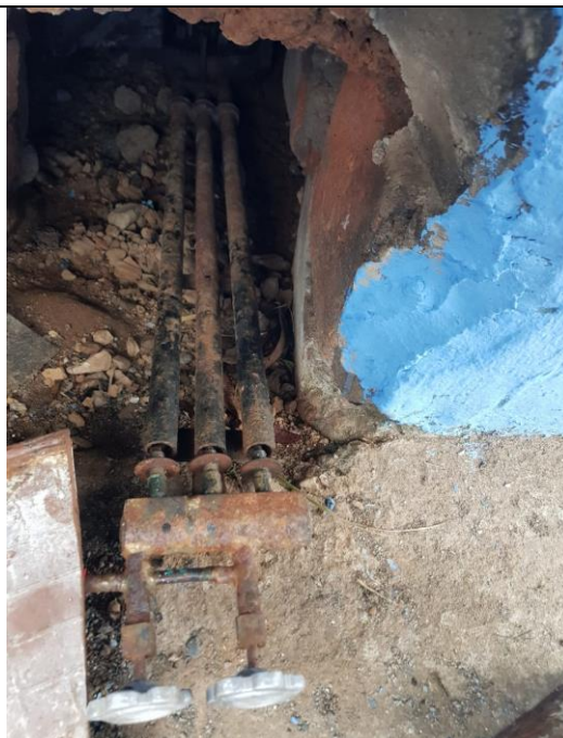
Anexos 14. Ingreso y reguladores de oxígeno para el gas, el mismo que será utilizado para el Biogás.
