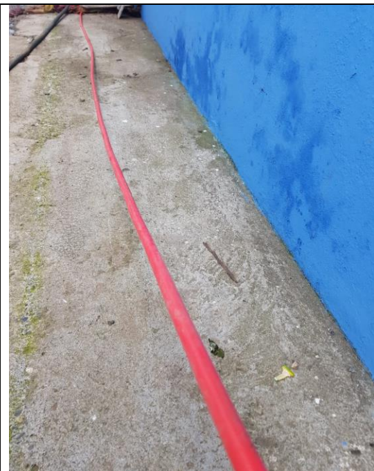
Anexos 13. Manguera que conduce el biogás; para la cocina y lo mechero de las calderas
