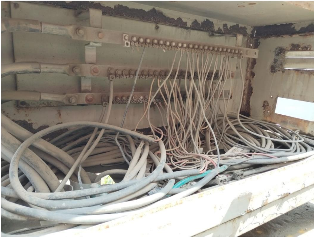
Anexo 5. Tablero de distribución deteriorado (Zona PTI)
