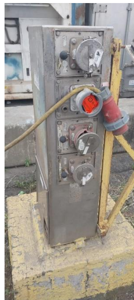
Figura 17 Tomas de conexión 440 V.
