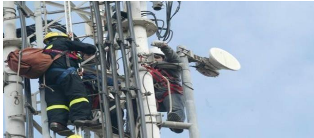
Figura 10 Línea de vida en torre
