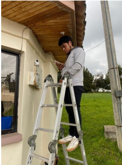
Ilustración 12: COLOCACIÓN DE CÁMARA PARA EL AFORO
