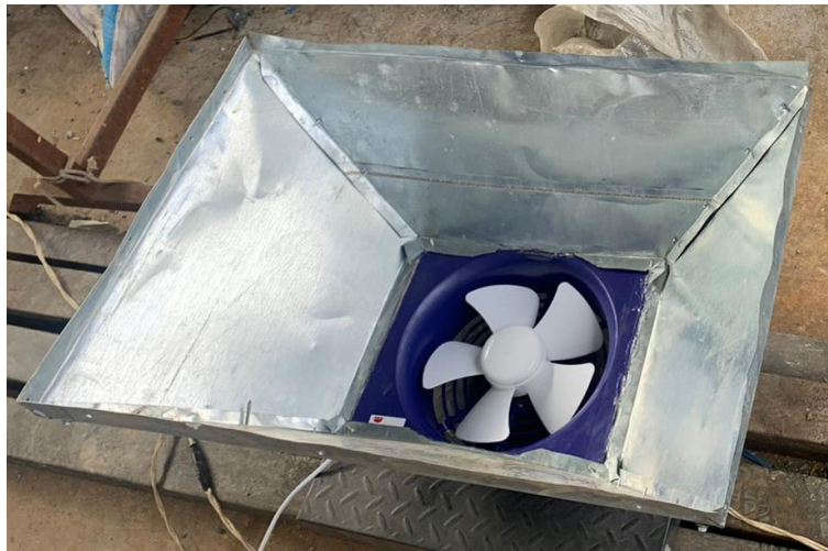
Figura 32 Unión entre la campana de extracción y el extractor CENTURY.
