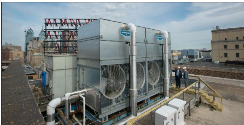
Figura 2 Torre de enfriamiento [5].
