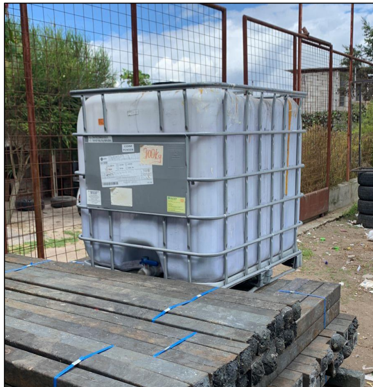
Figura 19 Reservorio de agua refrigerada de 1000 litros
