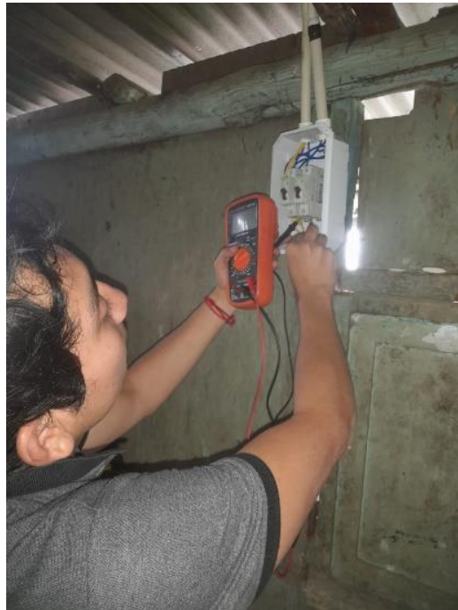
Anexos 11 Verificación de Continuidad en Fusibles (Autor)
