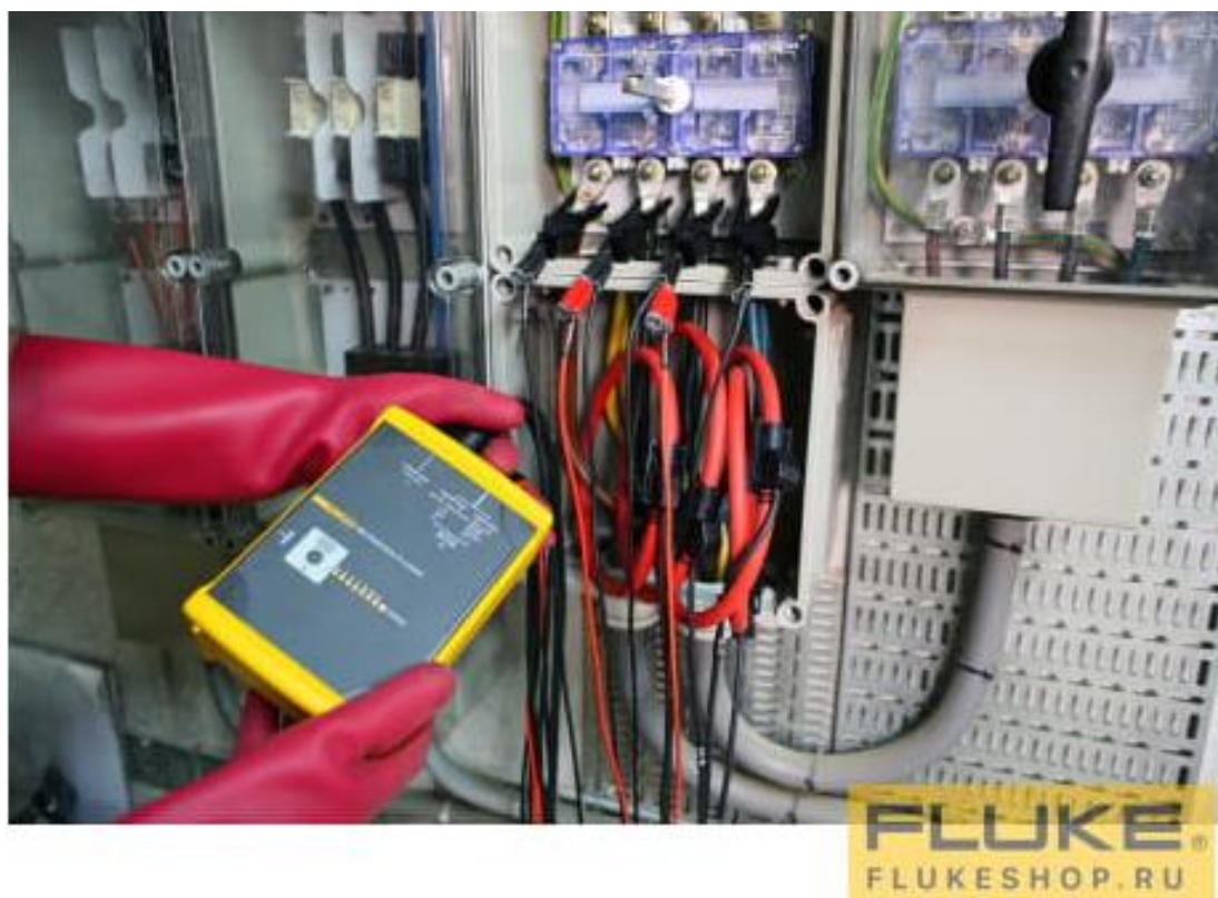
Figura 13 Instalación del Fluke 1744 [27].
