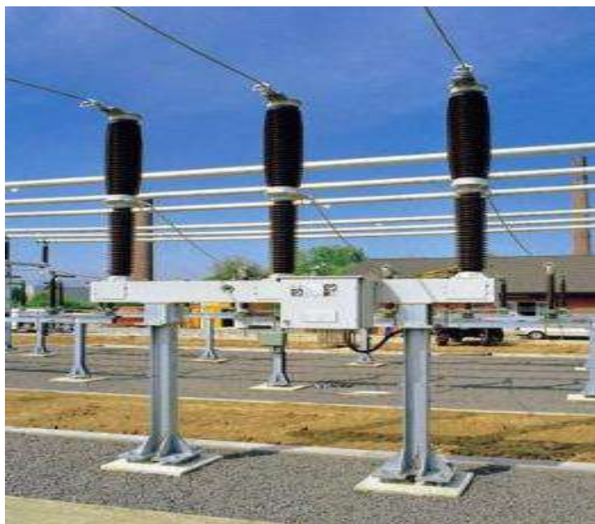
Figura 7: Disyuntor tanque vivo. [9]
