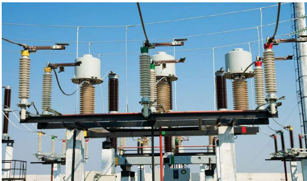
Figura 6: Seccionador usado en las subestaciones. [7]
