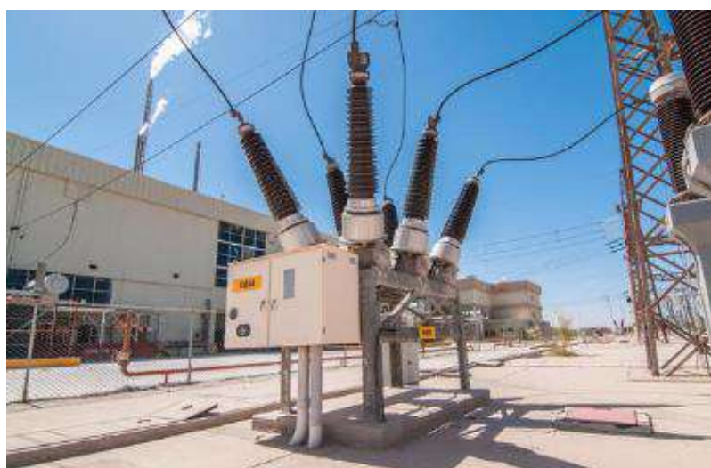
Figura 8: Disyuntor de Tanque muerto. [10]
