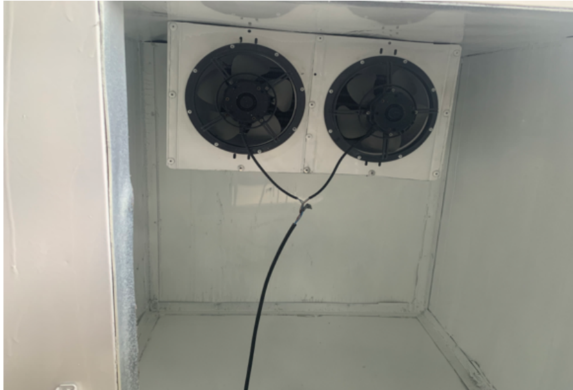
Figura 20. Ventiladores para evaporadores.
