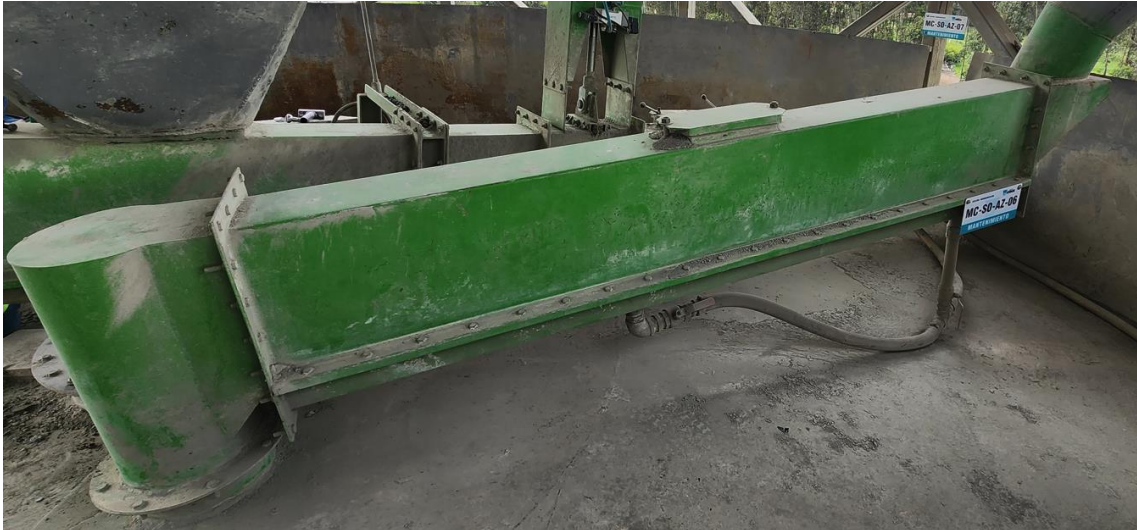
Figura 12. Aerodeslizador que alimenta el silo de Almacenamiento instalado.
