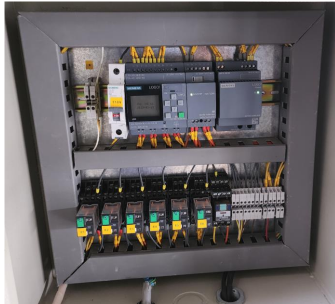
Figura 19. Control de desempolvado de las mangas en el filtro.
