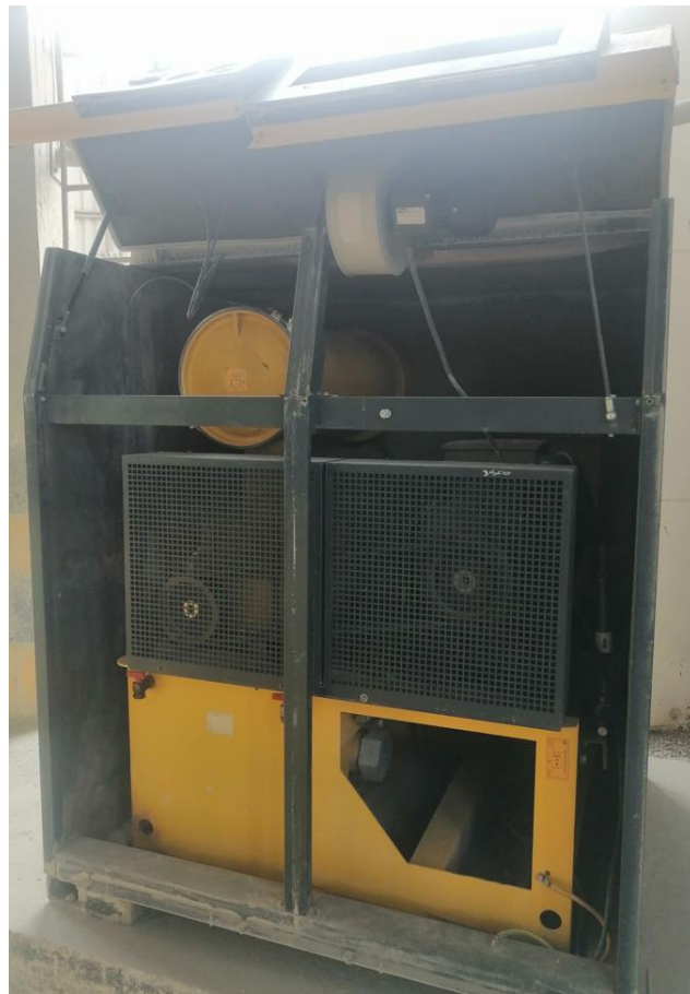
Figura 50. Motor del soplador Kaeser.
