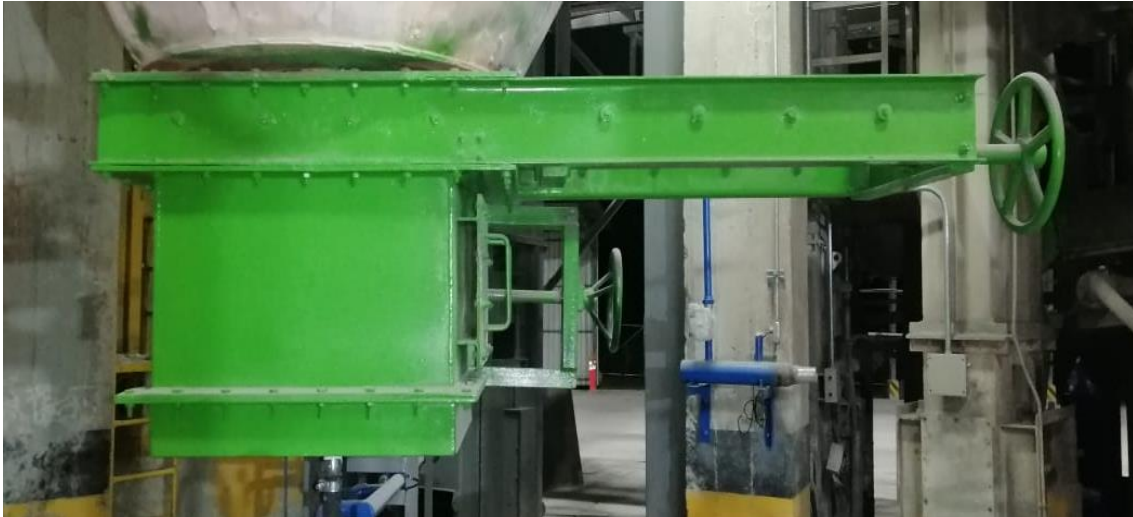
Figura 6. Compuerta manual instalada.
