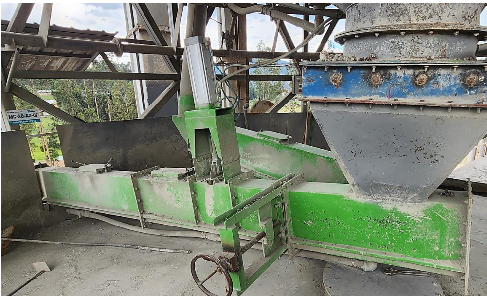
Figura 18. Aerodeslizador a la salida del silo de homogenización que alimenta la zaranda instalada.
