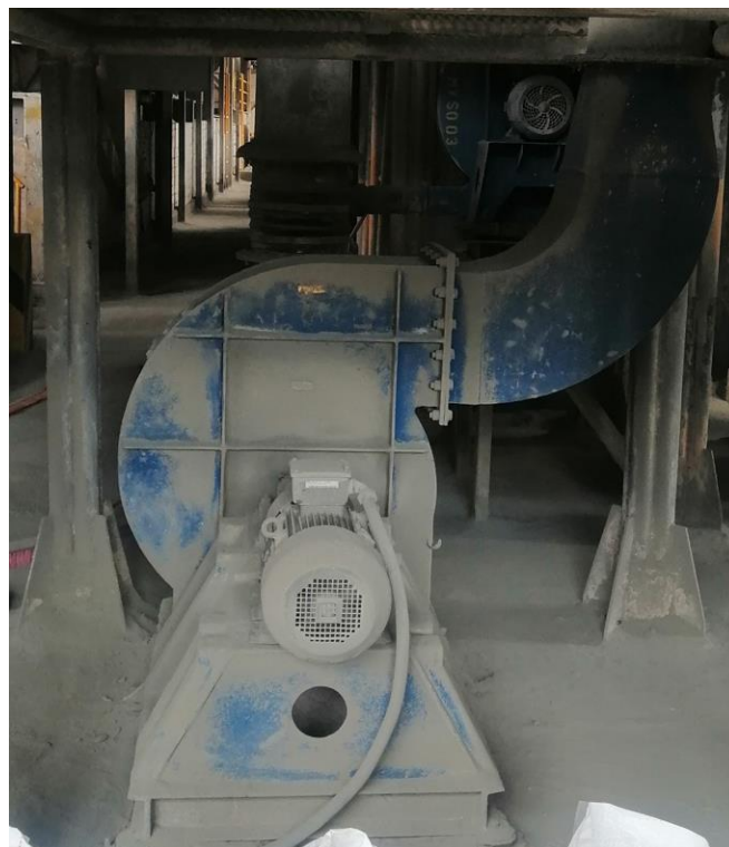
Figura 54. Motor del filtro de la zaranda y carro de despacho.
