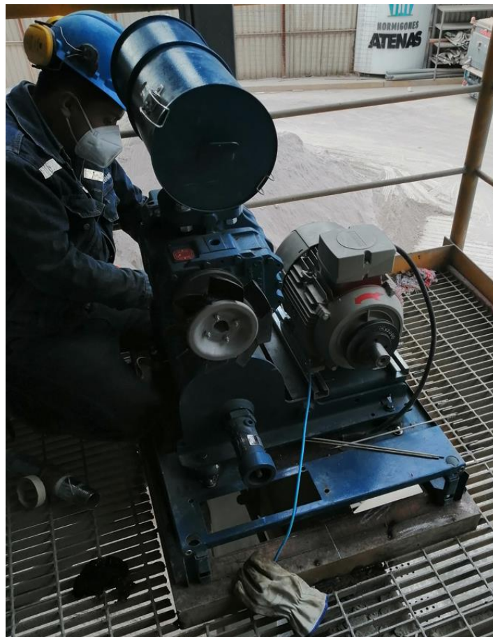
Figura 55. Motor de los aerodeslizadores que alimenta la zaranda y el carro de despachos.
