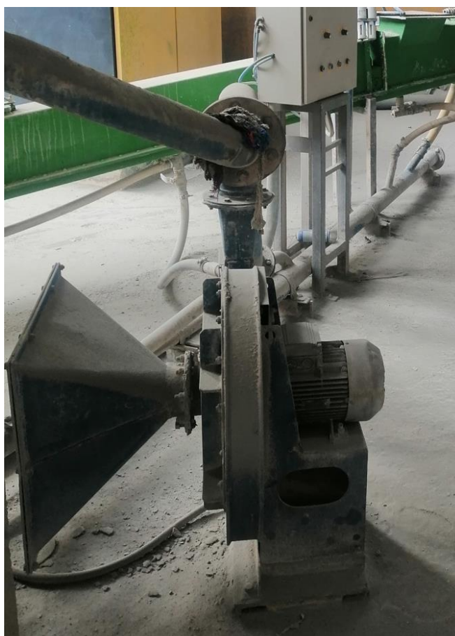
Figura 51. Motor de los aerodeslizadores de la salida del silo de almacenamiento.
