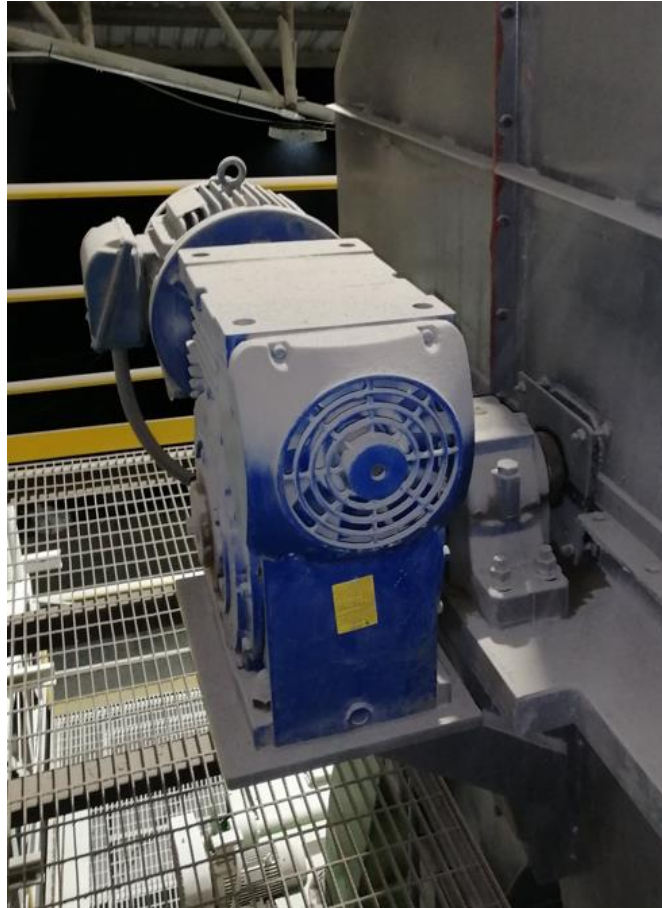
Figura 49. Motor del elevador de la salida del silo de almacenamiento.
