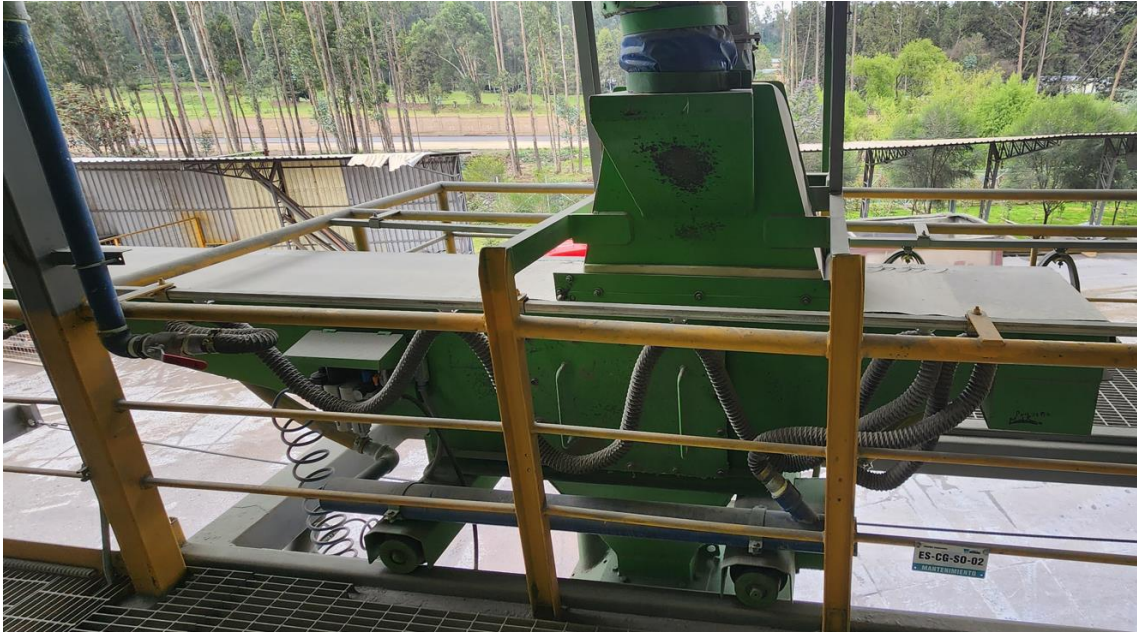
Figura 8. Carro de despacho instalado.
