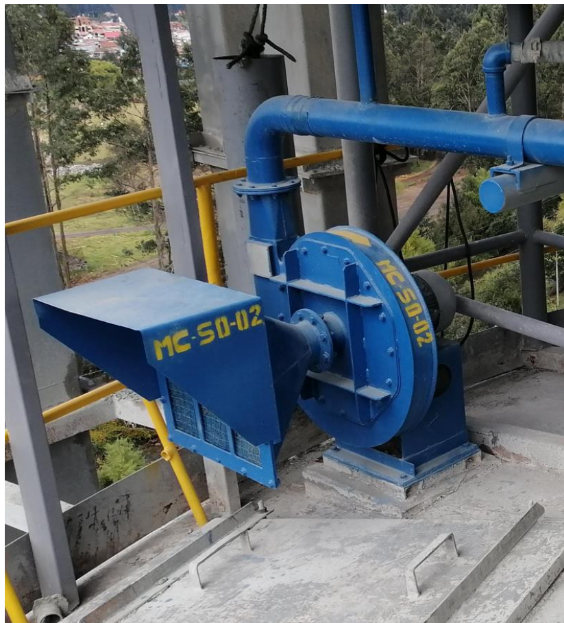
Figura 53. Motor del soplador de los aerodeslizadores del silo de homogenización.
