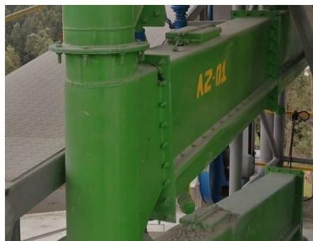
Figura 16. Compuerta del aerodeslizador de la salida del elevador MC-EC-MT01 instalado.
