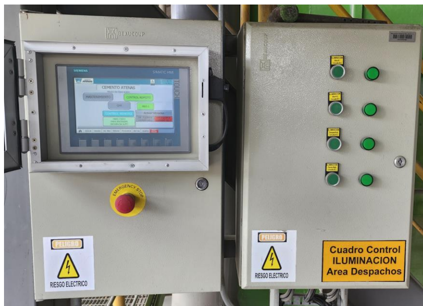
Figura 20. Tableros de control de la HMI y del sistema de iluminación de la zona de descarga a granel.
