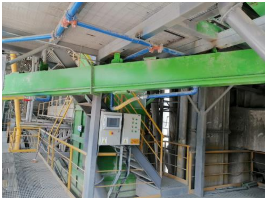
Figura 9. Aerodeslizador que alimenta el carro de despacho instalado.
