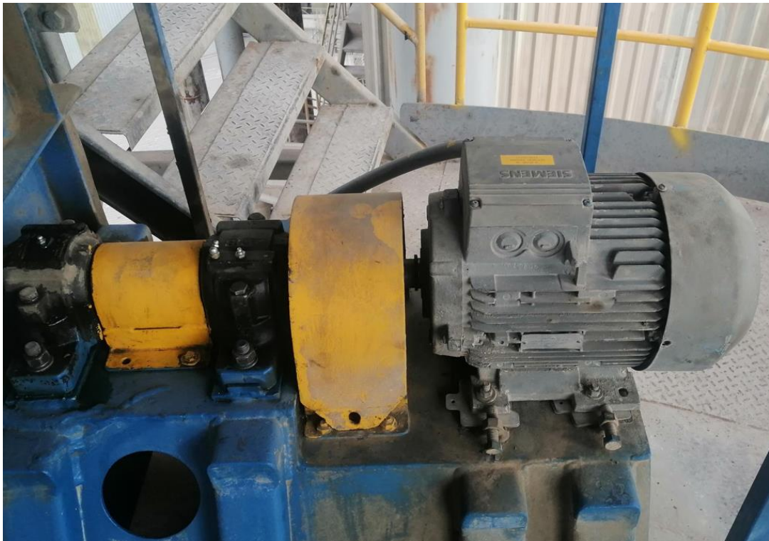
Figura 52. Motor del filtro del silo de homogenización.
