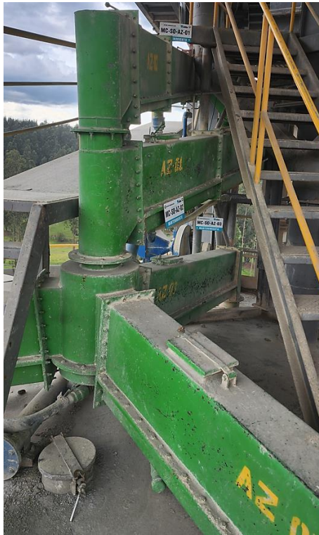
Figura 17. Compuerta del aerodeslizador que alimenta el silo de homogenización instalado.
