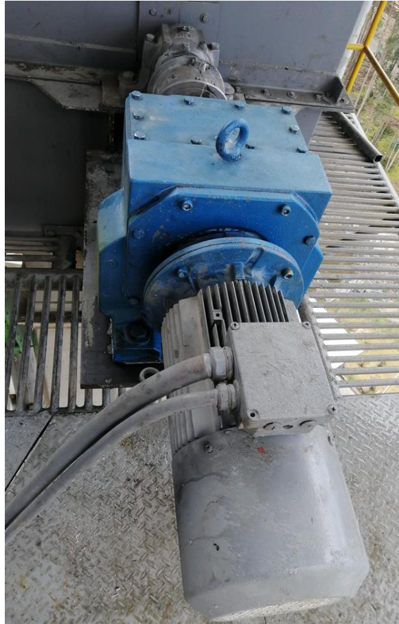
Figura 48. Motor del elevador del molino horizontal.
