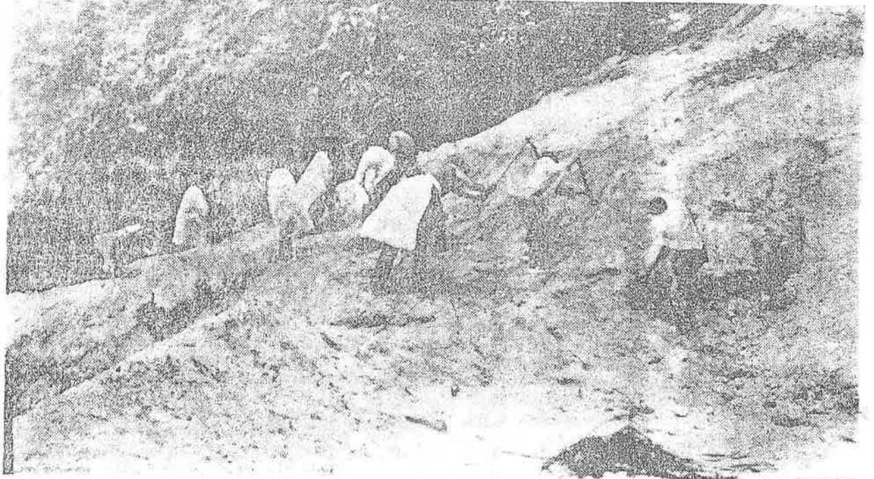
Los derrumbes afectan permanentemente a la carretera de Santa Bárbara - Sigundoy.
