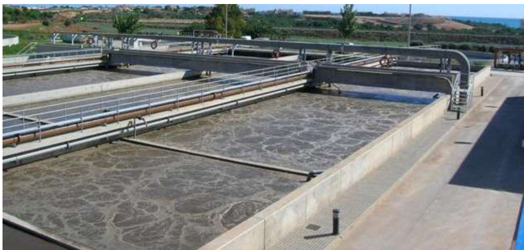
Figura 7. Desarenador de agua cruda
