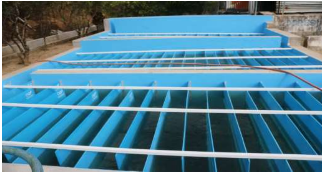
Figura 8. Sistema de floculadores
