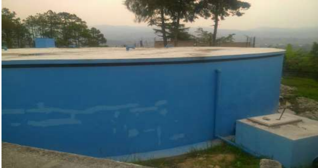
Figura 25. Tanque de almacenamiento
