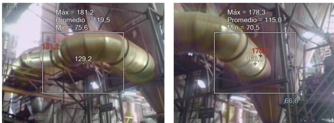
Figura 6.7 Termografía de ducto de transporte de material granulado desde alimentador hacia el separador Fuente: Autor
