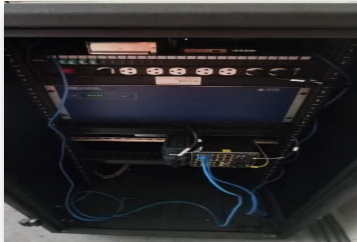
Figura 16: Armado de Rack de comunicación
