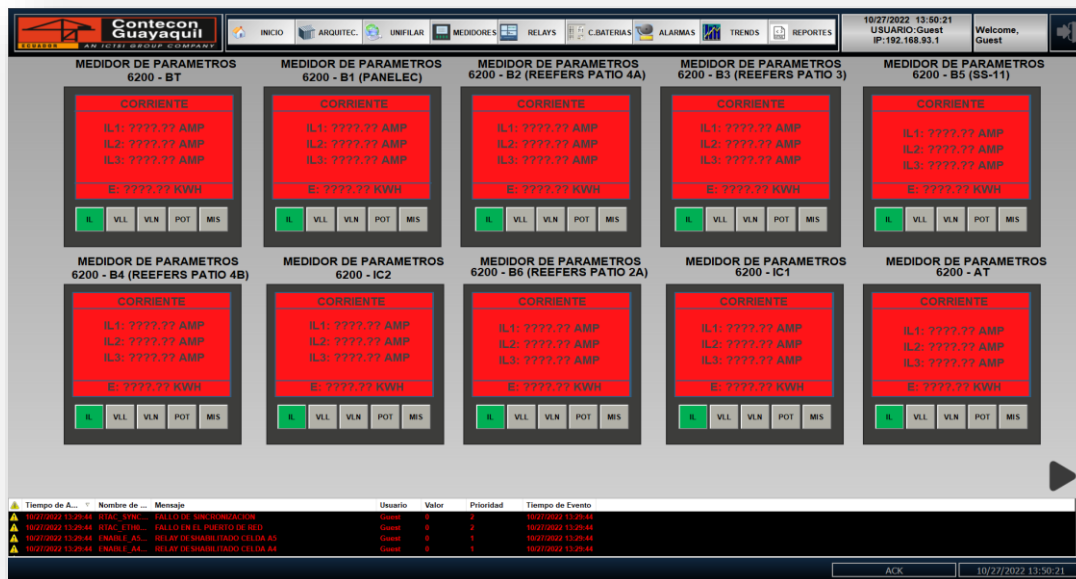
Figura 32: Pantalla de Medidores SCADA
