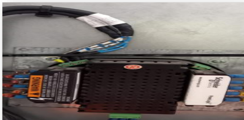
Figura 20: COM4 Modbus RS-485 a 2 hilos
