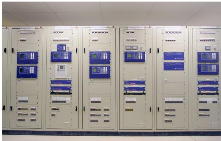
Figura 10: RELÉ DE PROTECCIÓN SEL
