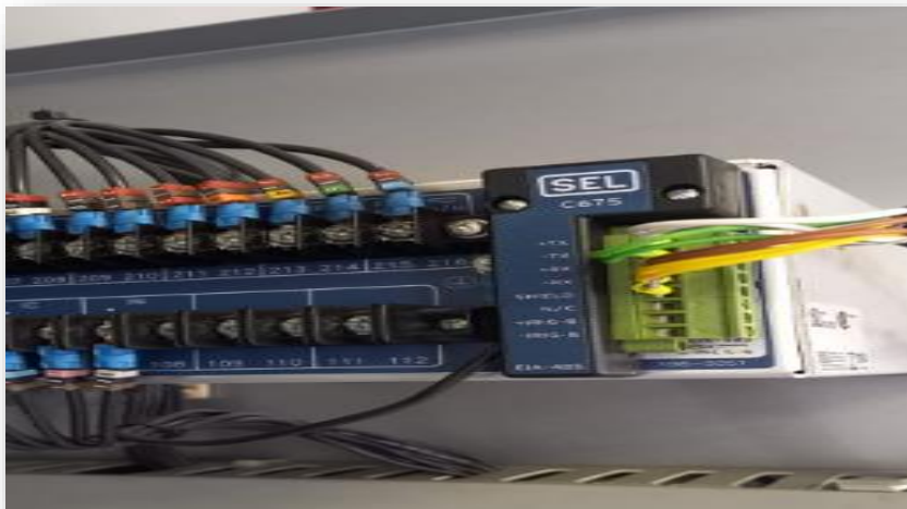
Figura 19: COM3 Modbus RS-485 a 4 hilos
