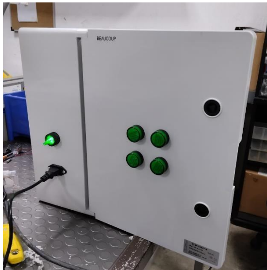
Figura 17: Luces piloto apagadas
