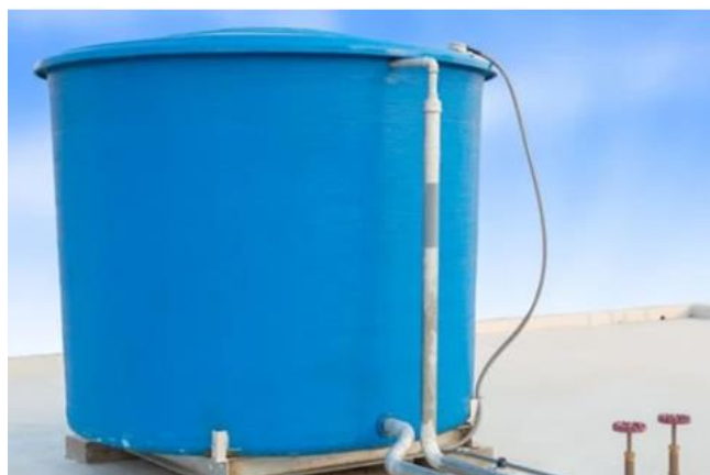
Figura 7: Tanque de almacenamiento de agua
