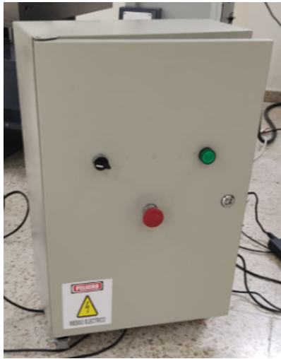
Figura 40: Caja de seguridad eléctrica.
