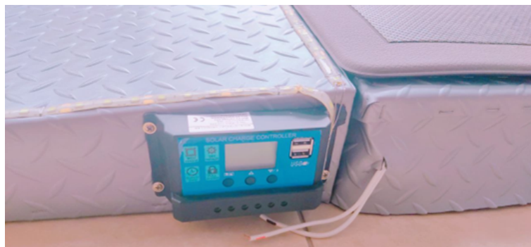
Figura 32. Controlador instalado en la rampa y su salida 5V-1A.
