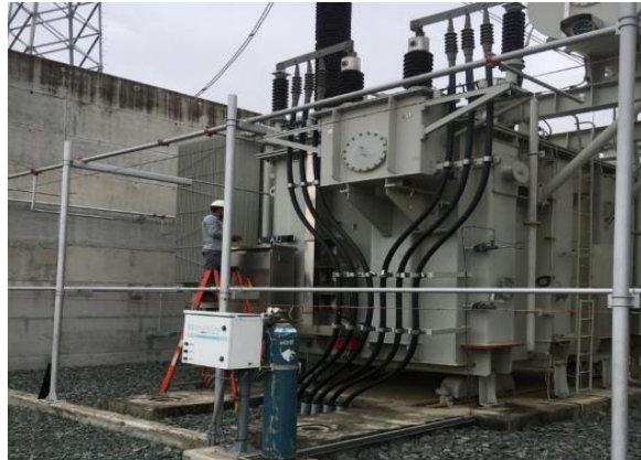
Figura 2 Autotransformador 500/230kV “S/E San Rafael” Fuente: Autor.
