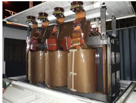
Figura 5 Bobinado de transformador 1500KVA Fuente: Autor.
