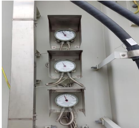
Figura 10 Indicadores de temperatura “S/E El Inga” Fuente: Autor.
