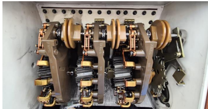
Figura 7 Cambiador de tomas (OLTC) "S/E Novacero" Fuente: Autor.
