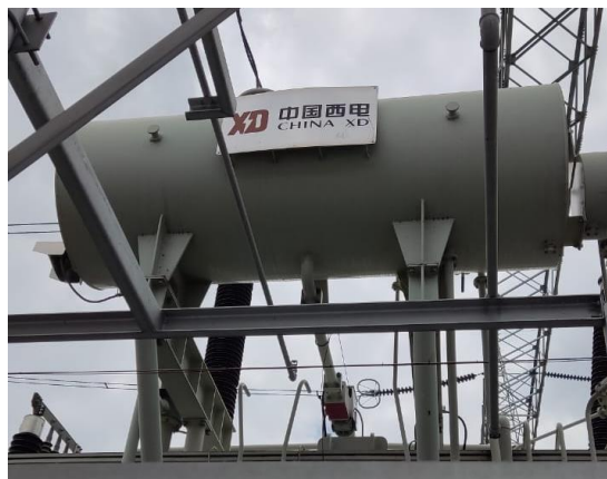
Figura 11 Tanque conservador “S/E El Inga” Fuente: Autor.
