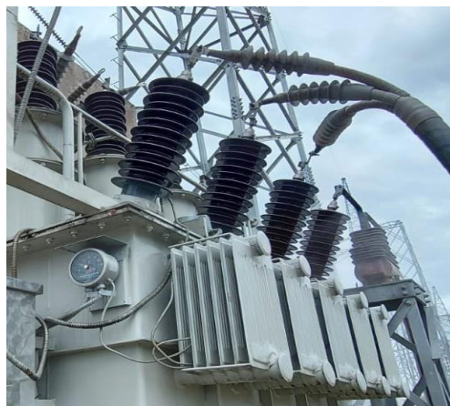
Figura 6 Bushings de transformador "S/E El Inga" Fuente: Autor
