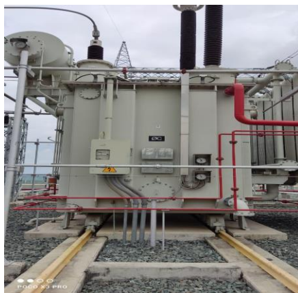
Figura 4 Cuba o carcasa del Autotransformador 500/230kV “S/E Chorrillos” Fuente: Autor.
