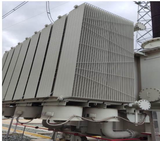
Figura 9 Radiador del Autotransformador 500/230kV “S/E Tisaleo” Fuente: Autor.
