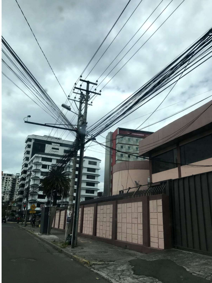
Figura 1. Red eléctrica de media tensión. Fuente: Autor.
