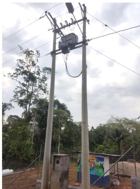
Figura 13. Ubicación de último poste de la red existente " San Vicente – Unión Esmeraldeña". Poste Pe1, tipo H de hormigón 12m. Numeración: 20110556. Fuente: Autor
