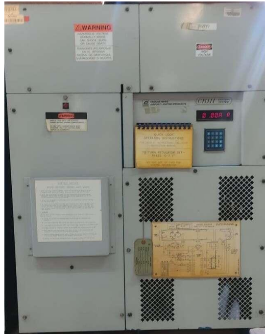
Figura 33: Equipos de regulación de corriente del RWY 2 de 20 kVA.
