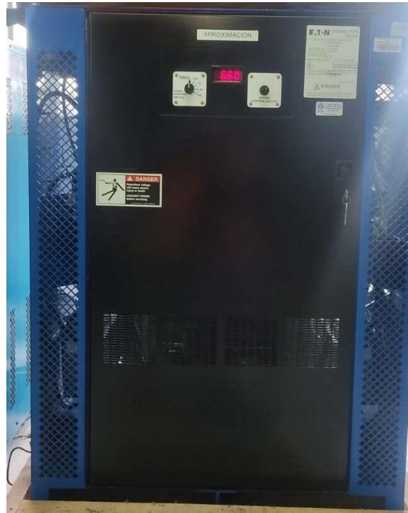
Figura 34: Equipos de regulación de corriente del de aproximación de 15 kVA. Fuente: Autores.
