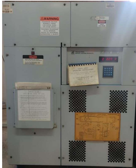
Figura 32: Equipos de regulación de corriente del RWY 1 de 15 kVA. Fuente: Autores.
