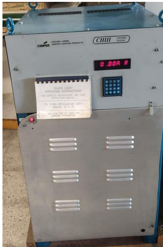
Figura 35: Equipos de regulación de corriente del de señalización de 7.5 kVA. Fuente: Autores.
