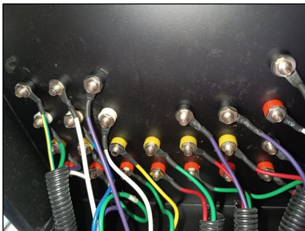
Figura 3-16. Instalación para toma de señales. 88
