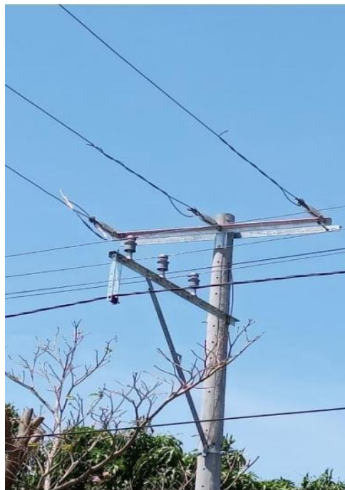
Figura No. 2 : Red de media tensión. Fuente [8]
