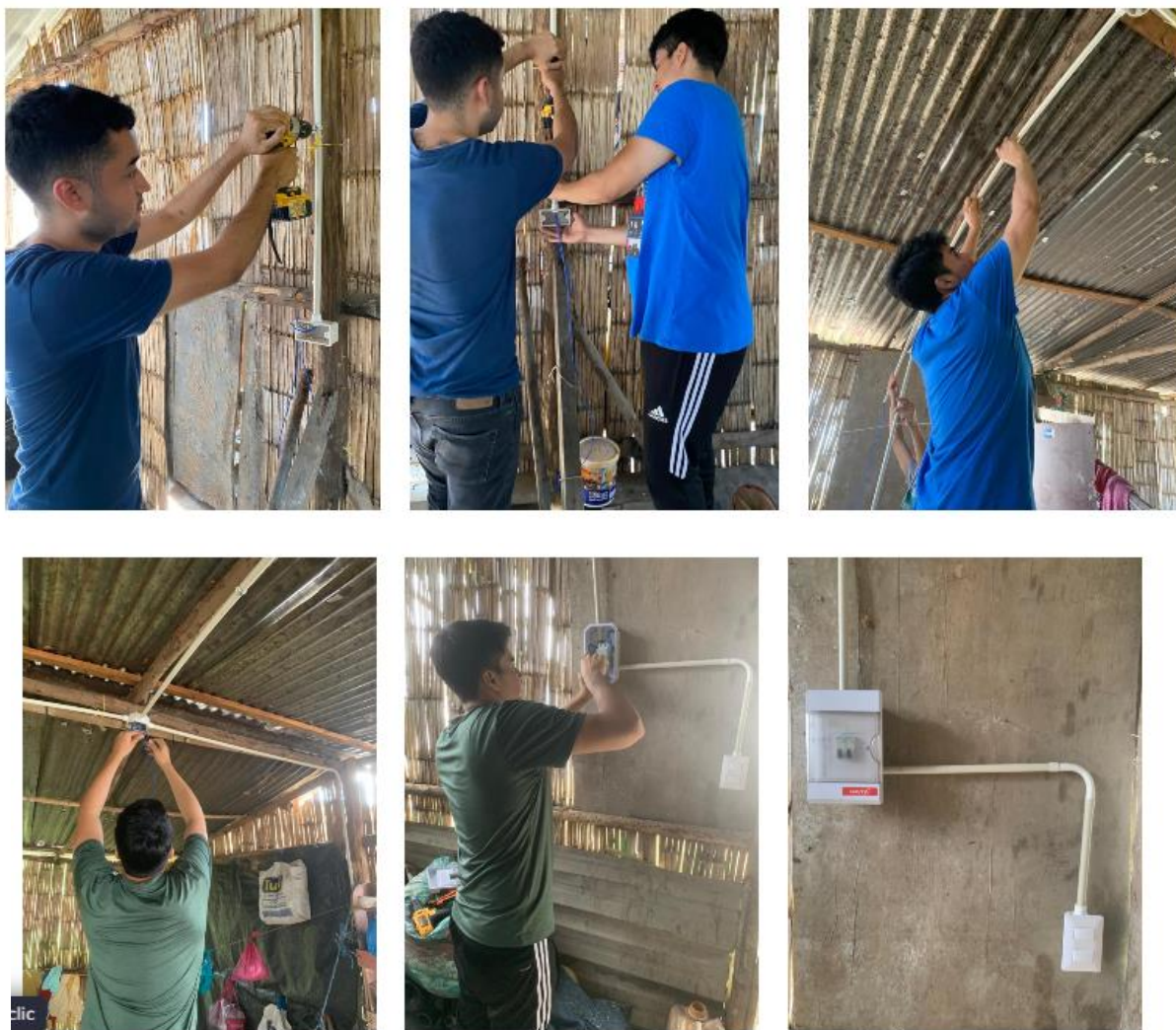
Figura 30. Instalación eléctrica de la vivienda
