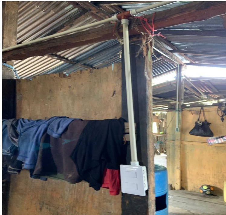
Figura 25.- Punto de interruptor doble para luminarias
