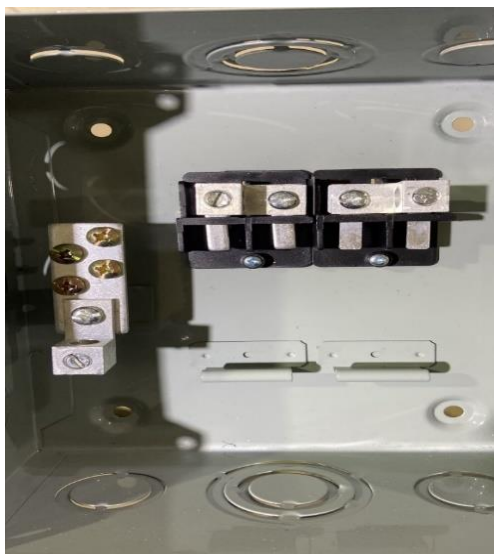
Figura 33 Panel de Distribución
