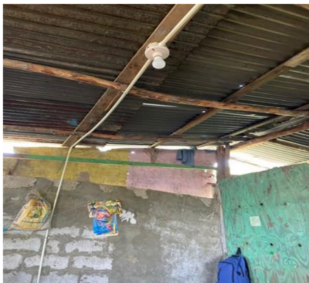
Figura 31 Instalaciones eléctricas de la vivienda
