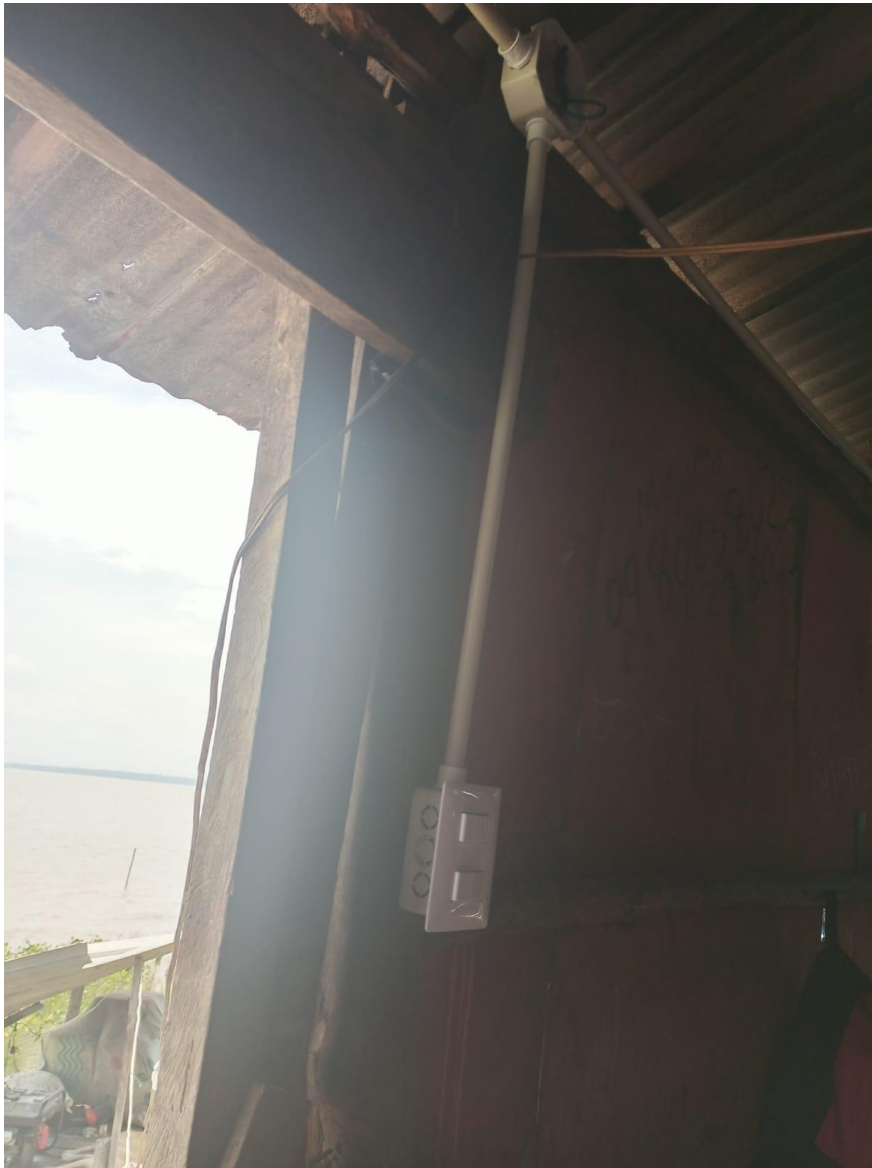
Ilustración 57: Puntos de interruptores
