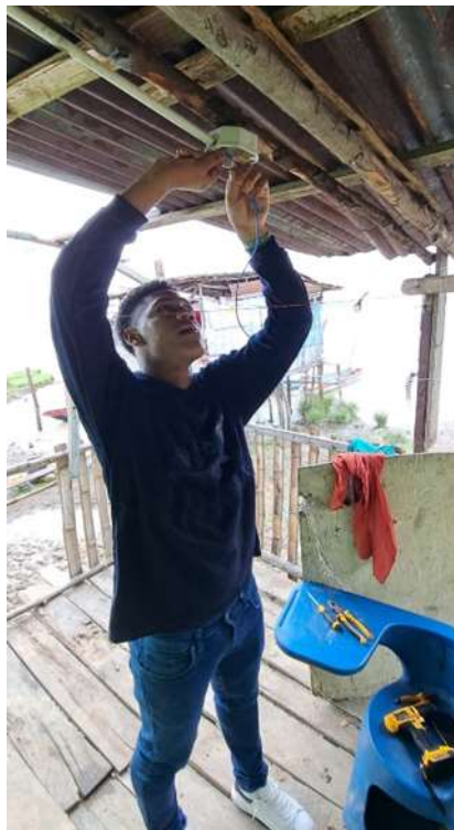
Figura 36: Cableado eléctrico de la vivienda.
