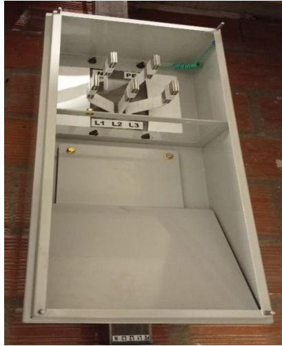
Figura 16 Caja de derivación. Fuente: Blindobarras by Cedal.
