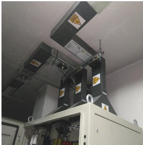
Figura 18 Conexión de tablero ingreso superior. Fuente: Blindobarras by Cedal.
