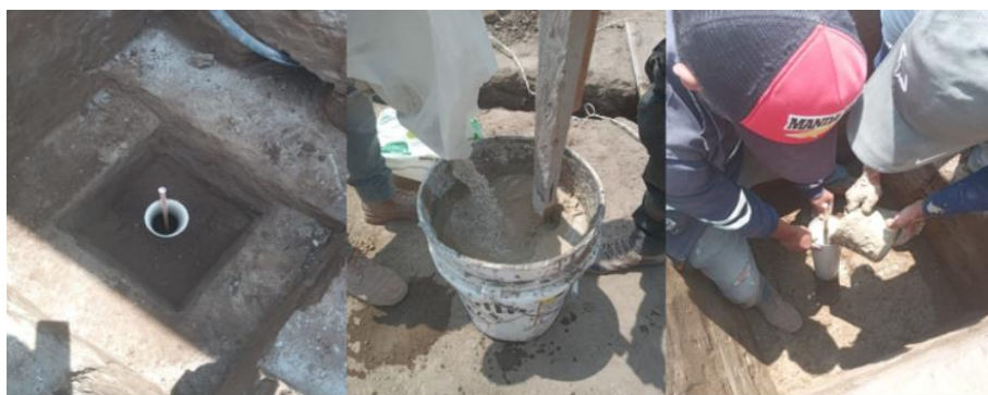
Figura 7 Método de instalación de sistema de puesta a tierra. Fuente: Endara Instalaciones.
