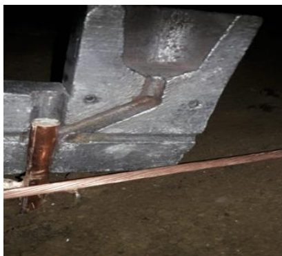
Figura 5 Conductor de puesta a tierra Fuente: Endara Instalaciones
