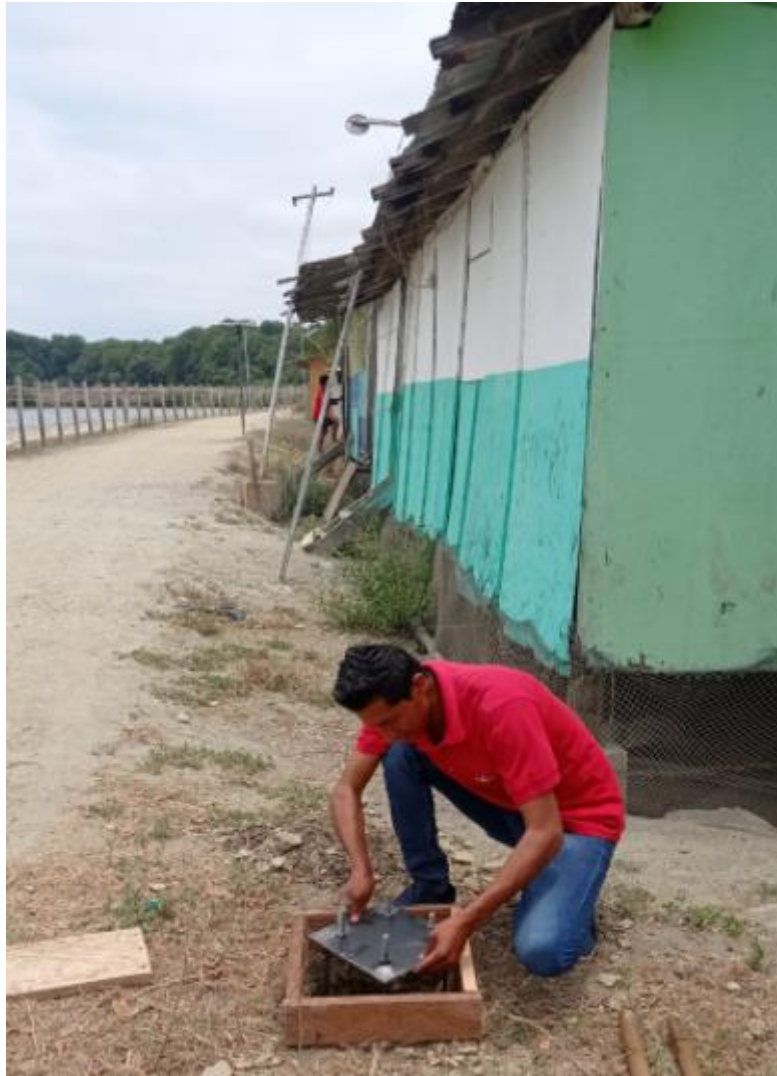
Figura 38. Fundición de la estructura que soporta la base del panel. Fuente: Los autores Completo el proceso de fundición de la columna que tiene una altura de 3 m se procede a la colocación del panel solar a una inclinación de 15^\circ con orientación hacia el sur, en la figura 39 se observa a los autores ubicación al panel sobre la estructura, desde allí se conecta la acometida en conductor #12 hacia el controlador de carga,
