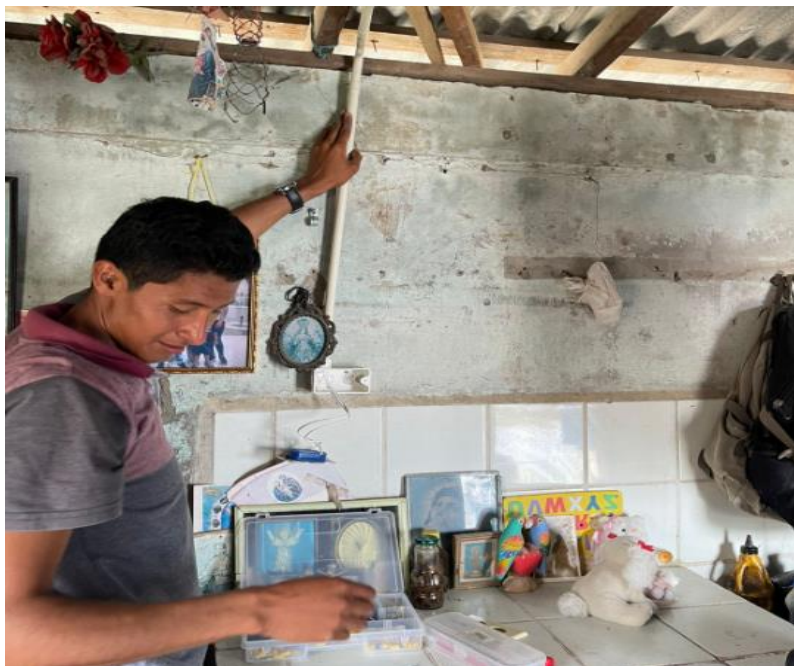
Figura 41. Instalación eléctrica residencial. Fuente: Los autores
