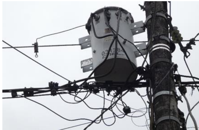
Figura 7 Transformador de potencia en la red de distribución. Fuente: Autor (Foto de campo Circuito 6 Red 13,8 kV Viche – El Roto).
