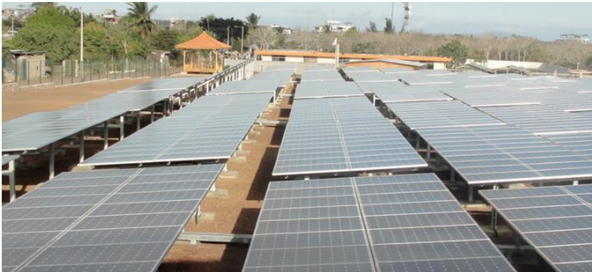
Figura 8. Matriz fotovoltaica para generación de electricidad
