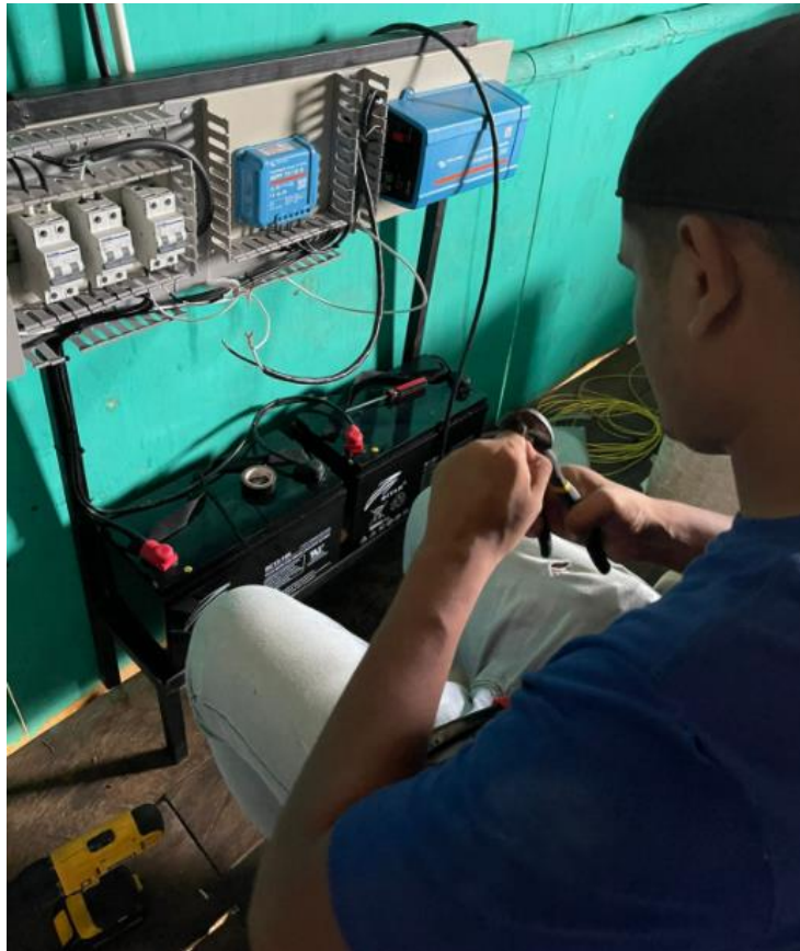
Figura 35. Apriete de terminales en la batería
