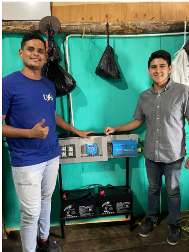
Figura 39. Implementación concluida del sistema fotovoltaico
