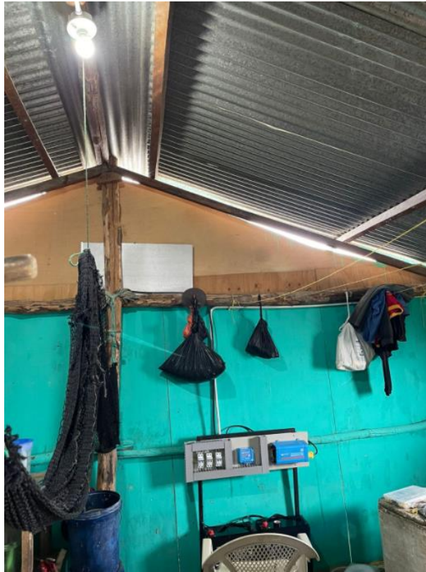
Figura 38. Luminaria encendida y vista del SF
