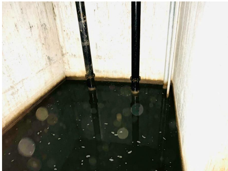
Figura 7. Cisterna del sistema de agua de enfriamiento de la Central Hidroeléctrica Alazán. Fuente: Autor, 2022.
