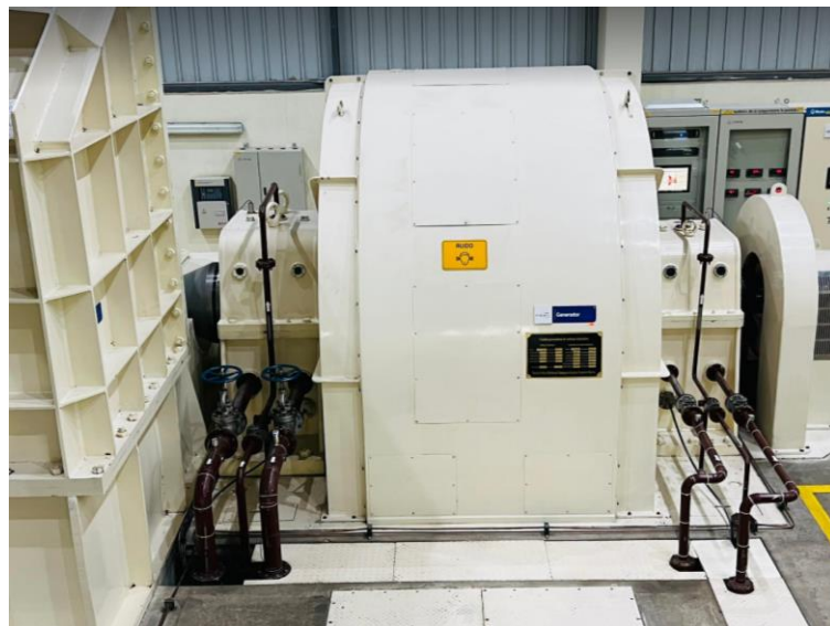
Figura 9. Generador síncrono de una central hidroeléctrica. Fuente: Autor, 2022.
