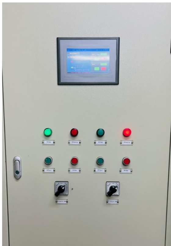
Anexo 6. Tablero para accionamiento de bombas del SAE. Fuente: Autor, 2022.
