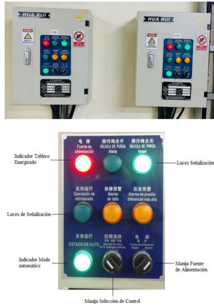
Anexo 7. Tablero de filtros autolimpiantes del SAE. Fuente: Autor, 2022.
