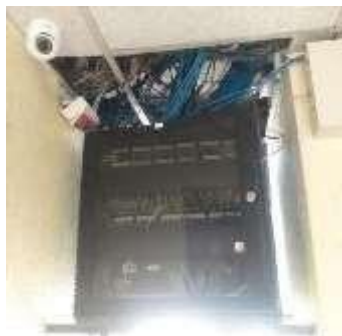
Ilustración 8 Rack o armario del piso 5 del edificio de la ARCOTEL encontrado en el exterior del CCDE. Fuente: ARCOTEL
