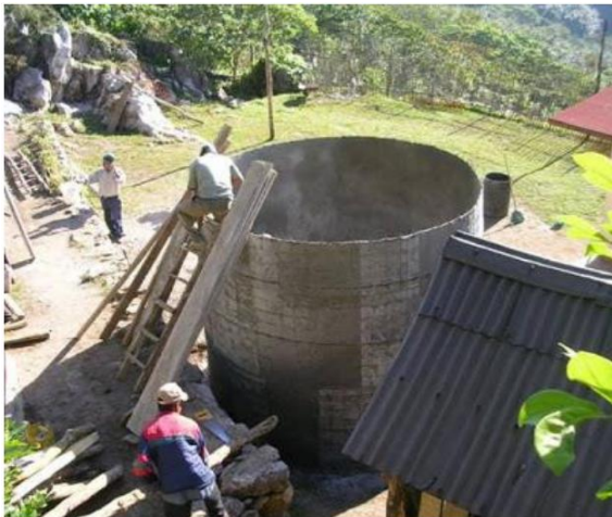
Tanque superficial de ferrocemento
