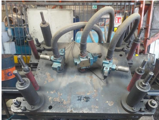
Fig. 10 Electroválvulas neumáticas para boya de presión
