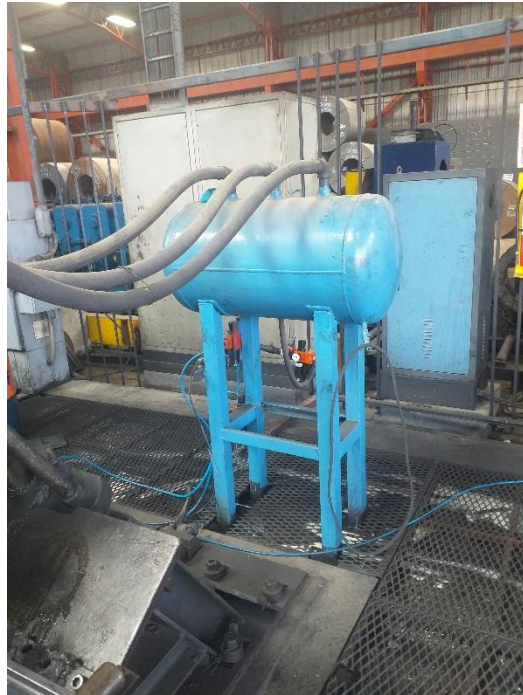
Fig. 8 Tanque pulmón de presión
