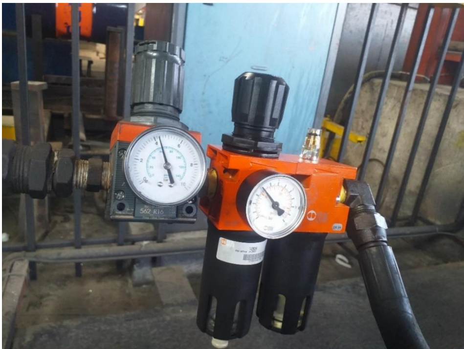
Fig. 23 Presión en tanque pulmón para boya de presión
