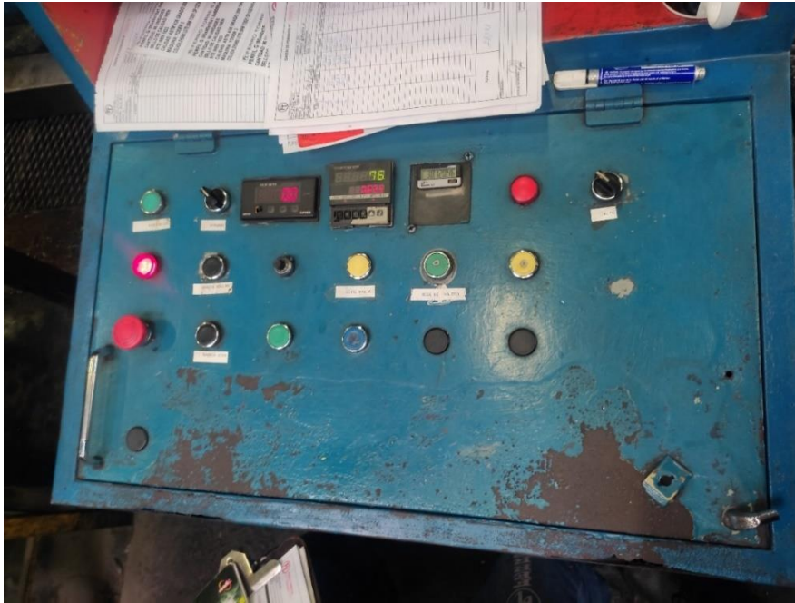
Fig. 70 Consola de control obsoleta vista externa
