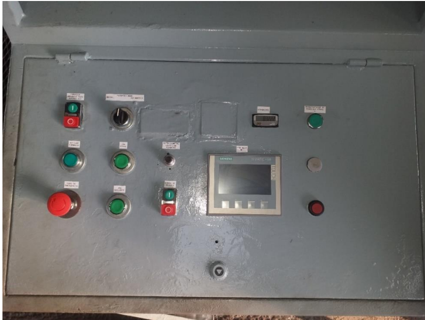
Fig. 73 Consola de control repotenciado vista externa
